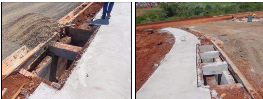
Figura 49: Bocas de Lobo em frente ao empreendimento. Fonte: Master Ambiental, 2019.
