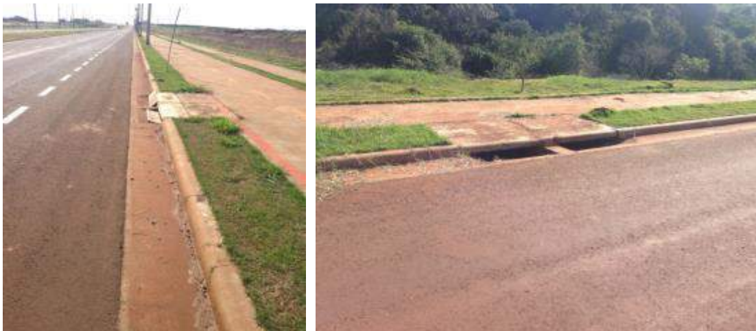
Figura 47: Bueiros na Rua 1. Fonte: Master Ambiental, 2018.
