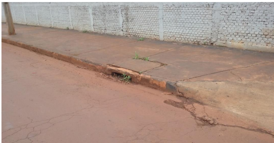
Figura 22: Galeria de coleta de águas pluviais em frente ao empreendimento. Fonte: Autor, 2017.
