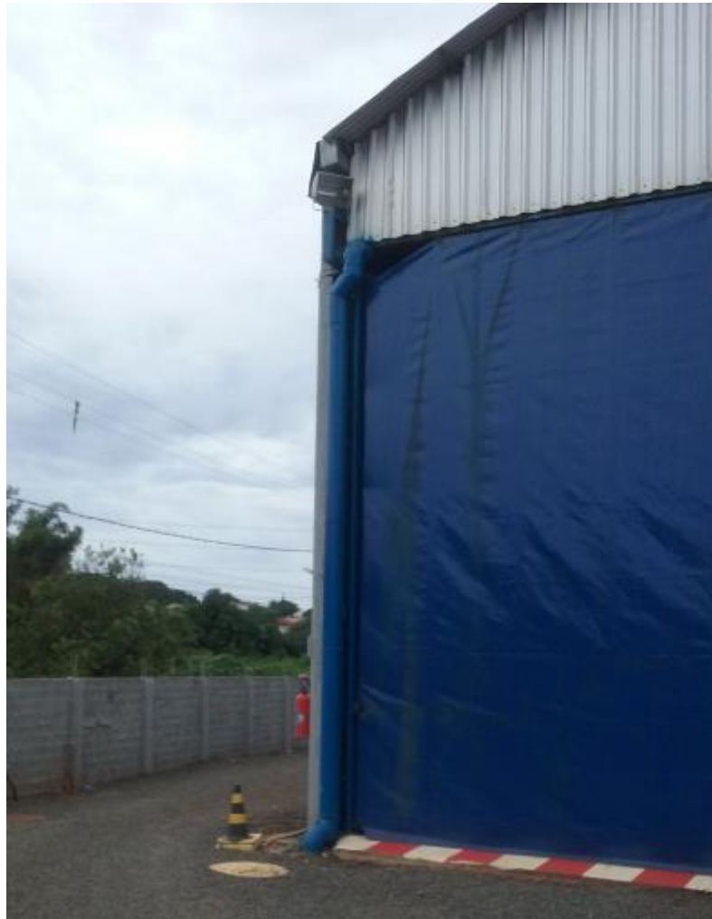
Figura 19: Tubulação coletora de águas pluviais incidentes no telhado. Fonte: Autor, 2017
