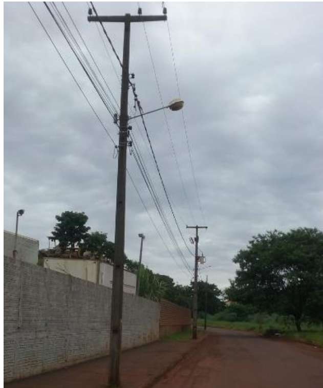
Figura 23: Iluminação pública na Rua Edmur Elias Neder. Fonte: Autor, 2017.
