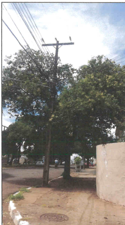
Figura 334: Conflito entre a fiação elétrica e a arborização da Rua Flamengo. Fonte: CS Consultoria Ambiental.
