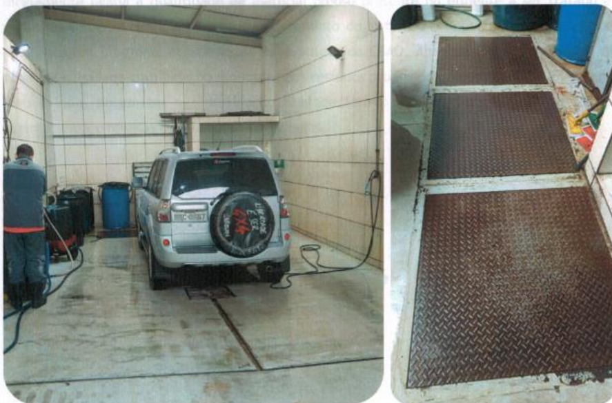
Figura 5: Lavador de veículos automotores juntamente com as caixas que fazem o tratamento do efluente da lavagem de veículos.
