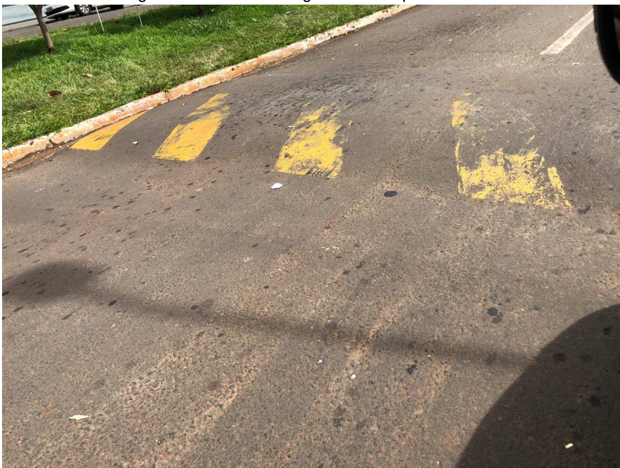
Figura 04 — Pintura desgastada dos quebra-molas
