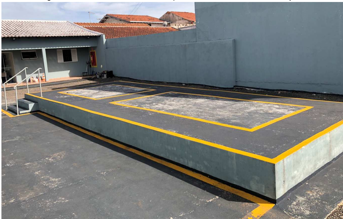
Figura 04 — Plataforma elevada para armazenamento de botijões
