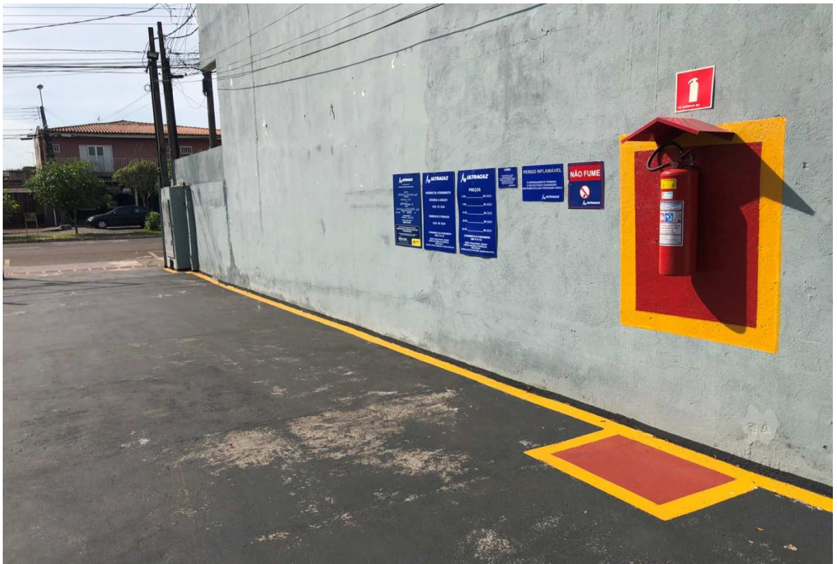
Figura 04 — Extintor de incêndio e placas de sinalização e especificação
