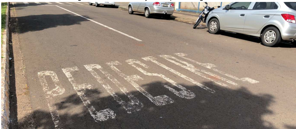
Figura 04 — Sinalização de piso desgastada
