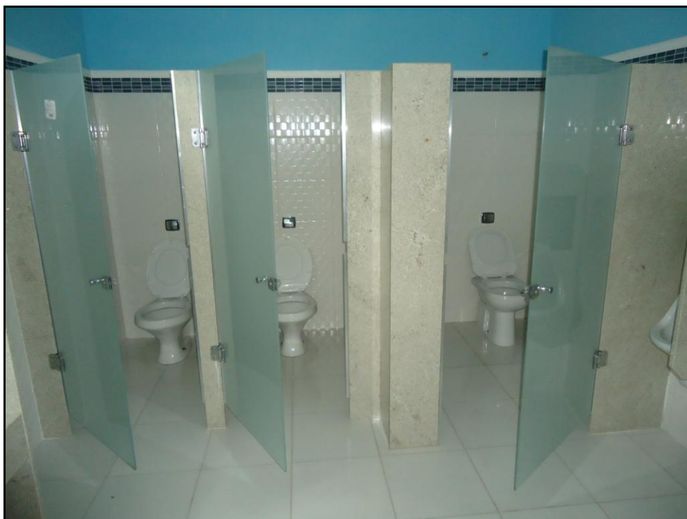
Foto 6 – Banheiro com uma porta (à direita) com acesso especial
