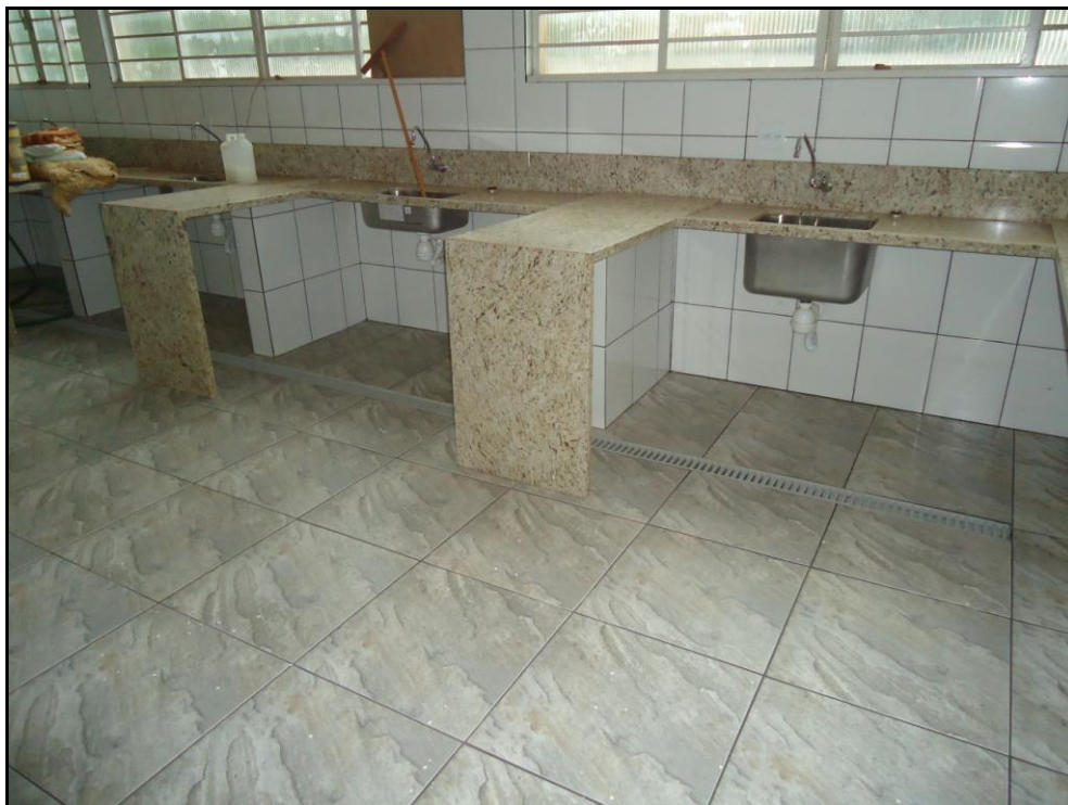
Foto 7 – Vista parcial da cozinha com atenção à grela para coleta dos efluentes
