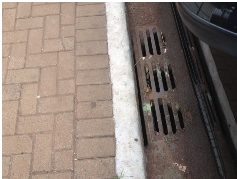
Figura 6 – Boca de lobo frente ao empreendimento. 05/09/2016. Fonte: Vítor Ricci
