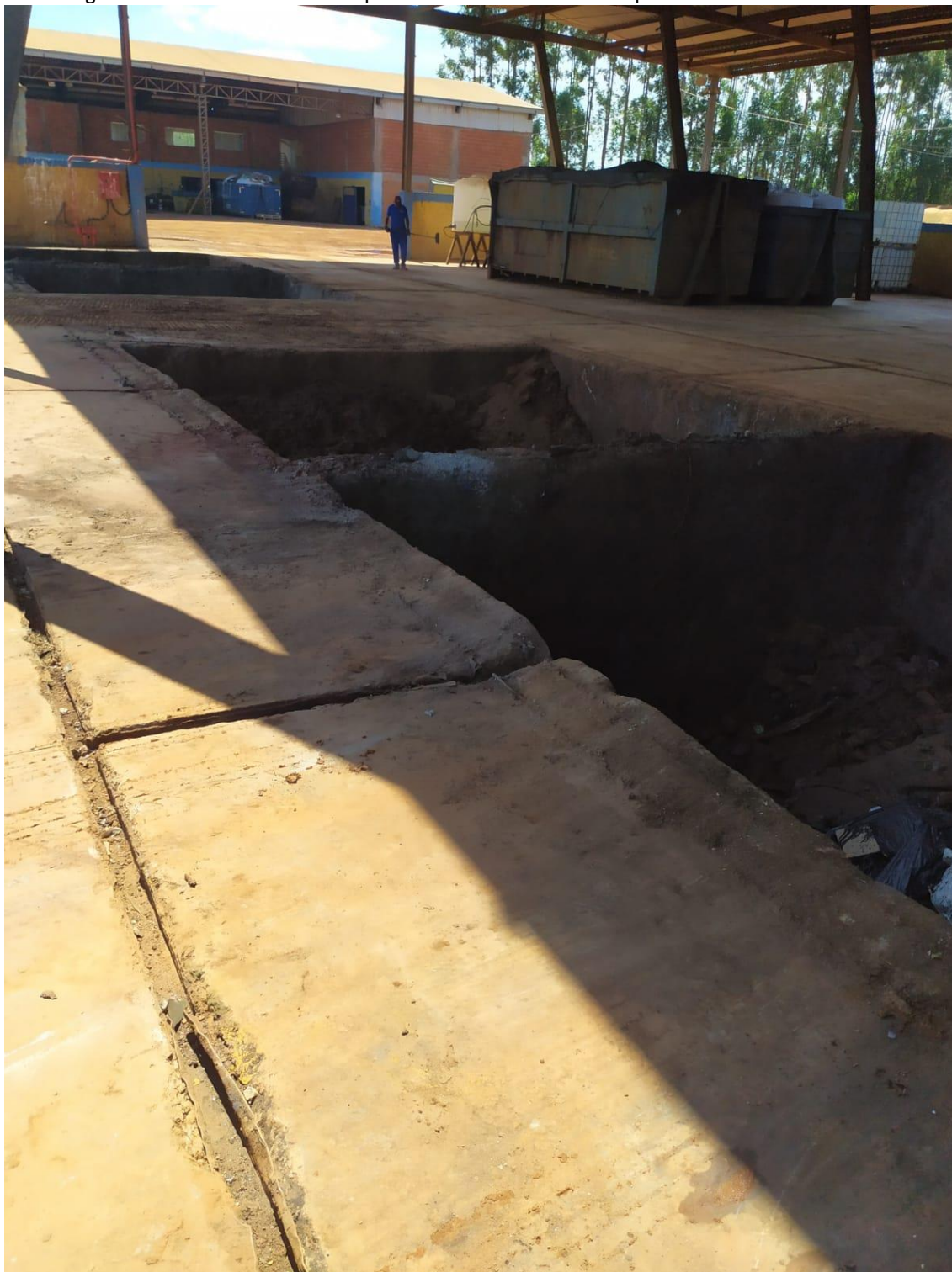
Imagem 08 – Canaletas coletoras que direcionam seu conteúdo para a vala de resíduos classe I
