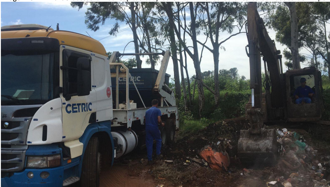
Imagem 32 – Via de acesso a Rua Capitão Jacy da Silva Pinheiros durante as atividades de limpeza
