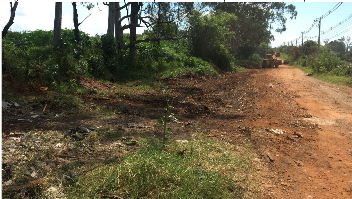
Imagem 42 – Via de acesso a Rua Capitão Jacy da Silva Pinheiros após as atividades de limpeza
