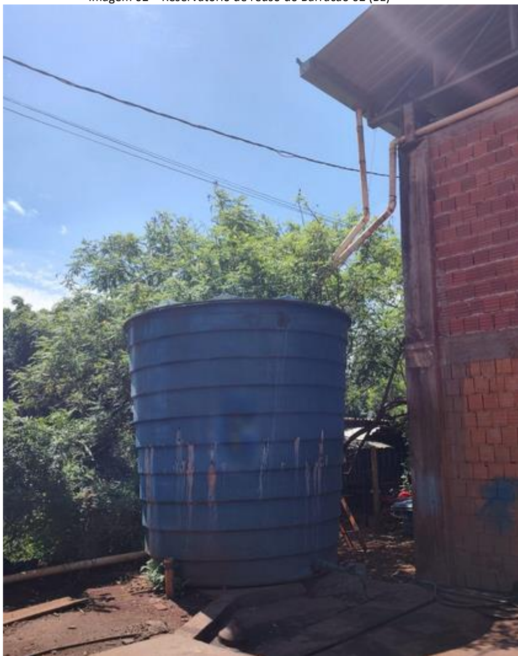
Imagem 02 – Reservatório de reuso do Barracão 02 (B2)
