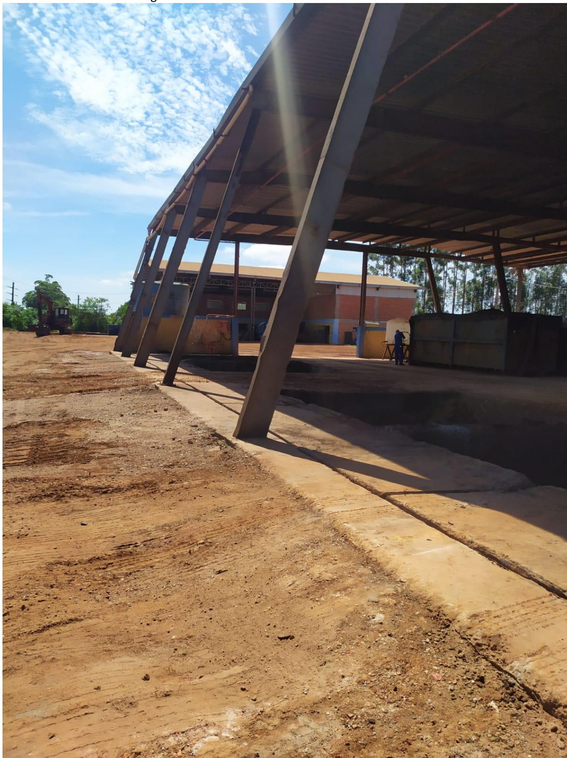
Imagem 09 – Canaletas coletoras ao redor do barracão 01
