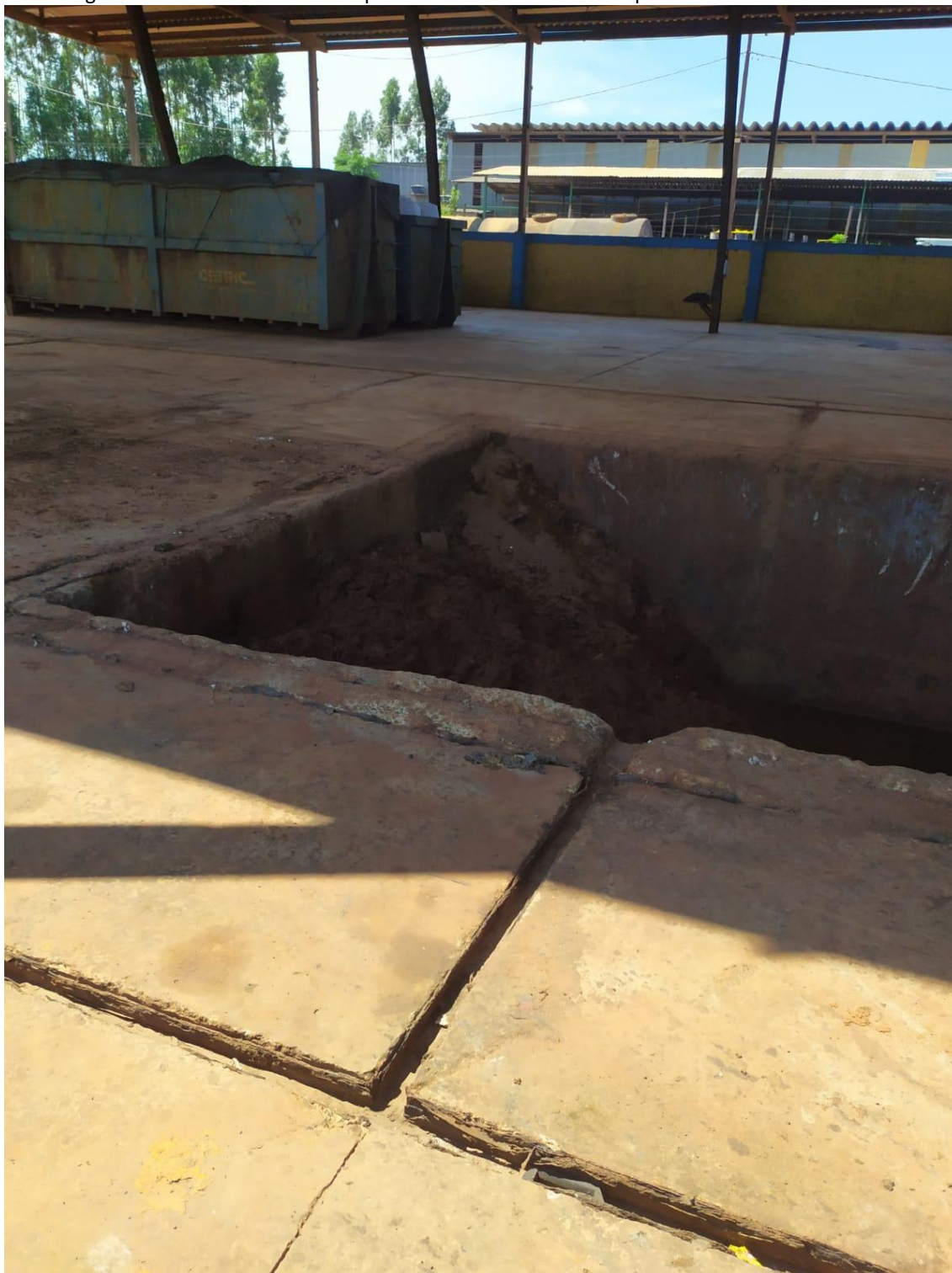
Imagem 07 – Canaletas coletoras que direcionam seu conteúdo para a vala de resíduos classe I
