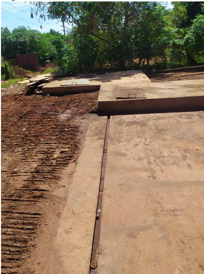
Imagem 25 – Visão das canaletas coletoras do barracão 02 direcionadas a CAT
