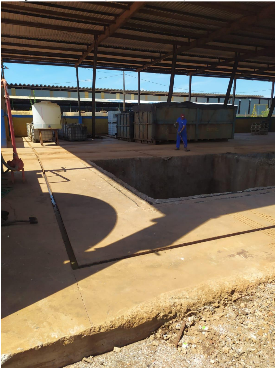
Imagem 06 – Canaletas coletoras que direcionam seu conteúdo para a vala de resíduos classe I
