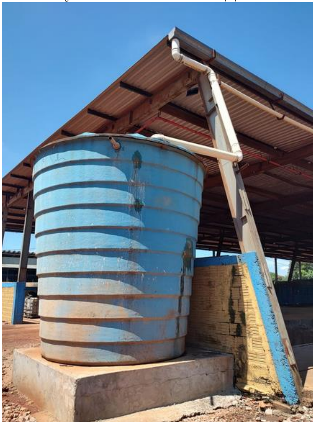
Imagem 01 – Reservatório de reuso do Barracão 01 (B1)
