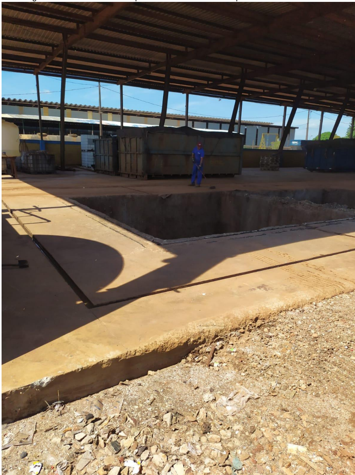
Imagem 05 - Canaletas coletoras que direcionam seu conteúdo para a vala de resíduos classe I
