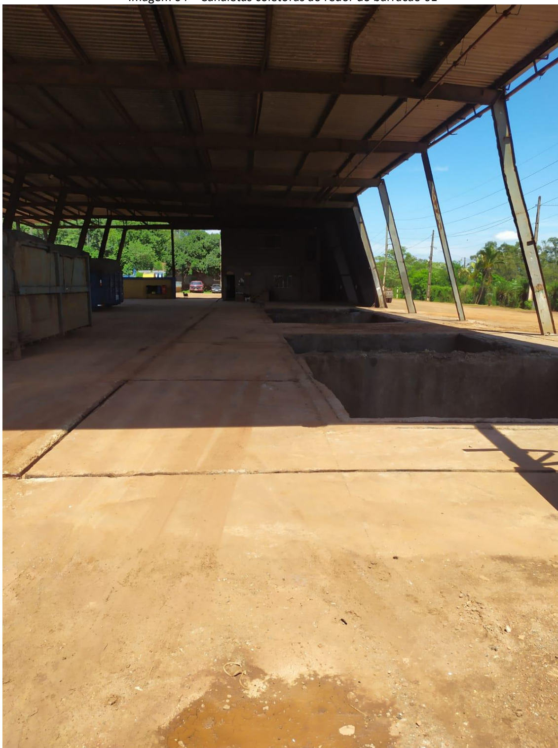
Imagem 04 – Canaletas coletoras ao redor do barracão 01
