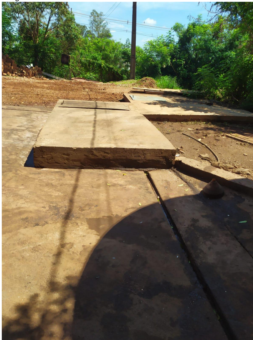
Imagem 24 – Visão das canaletas coletoras do barracão 02 direcionadas a CAT
