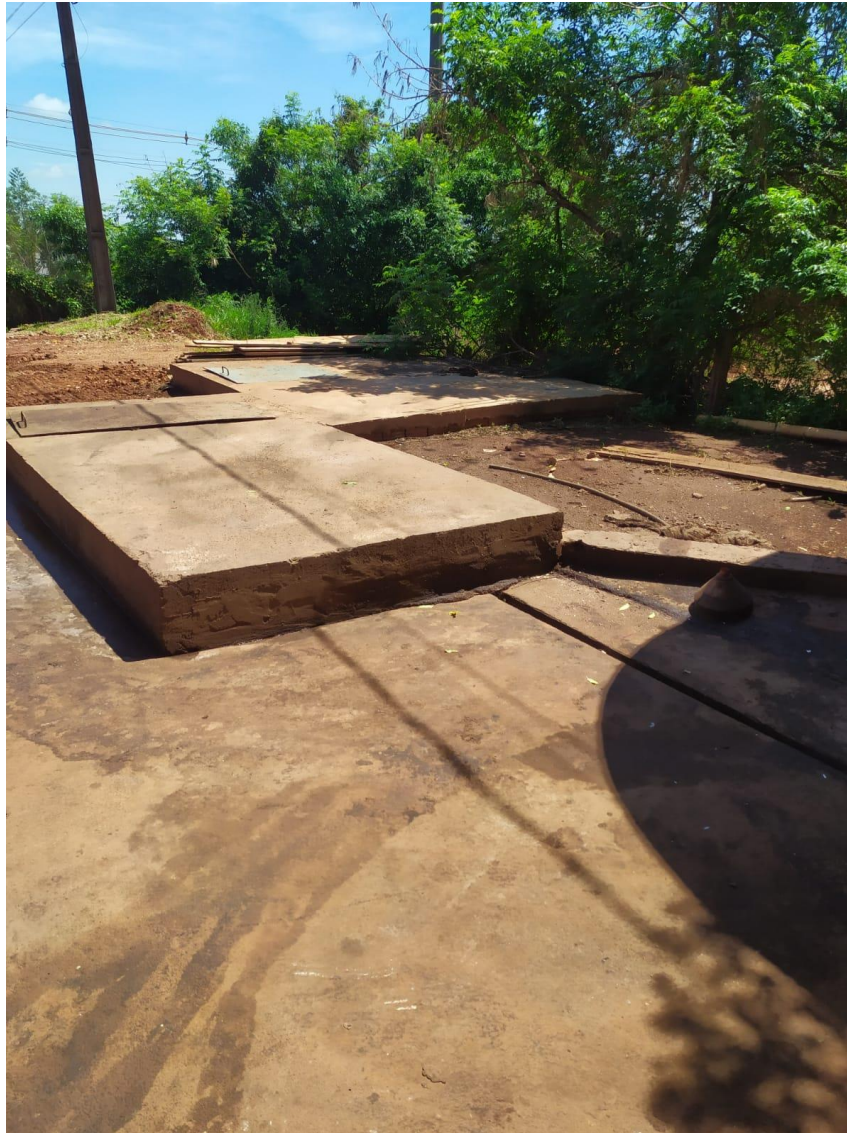
Imagem 23 – Visão das canaletas coletoras do barracão 02 direcionadas a CAT
