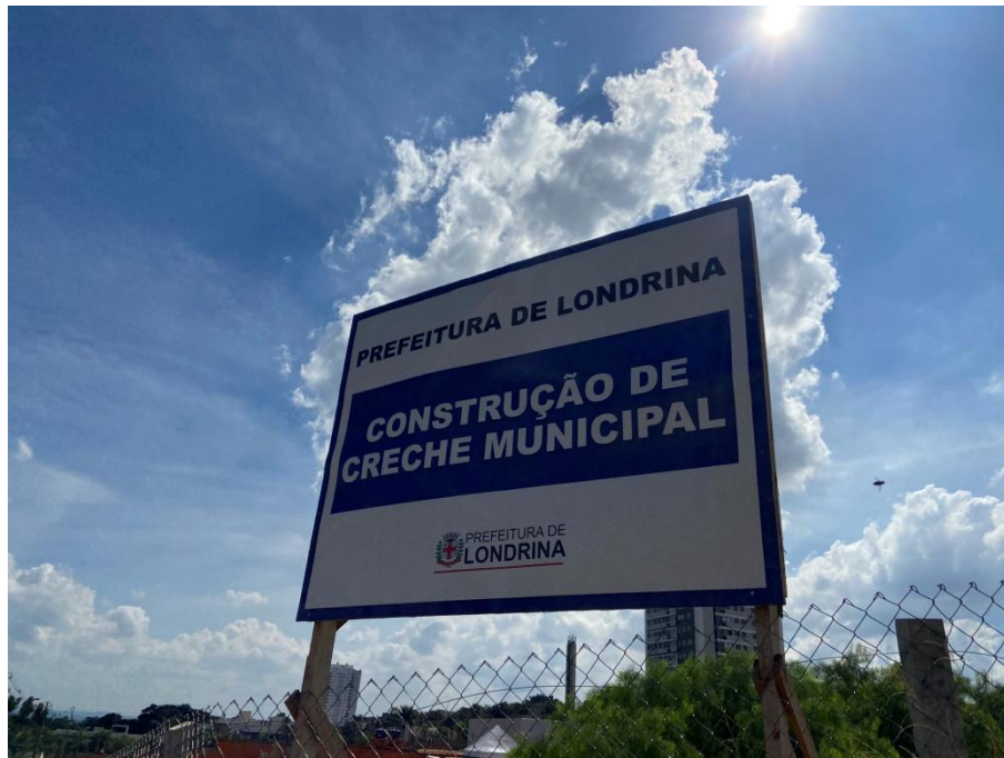
Figura 12: Creche municipal em fase de obras na Rua Luis Lerco. Fonte: Master Ambiental, 2024.
