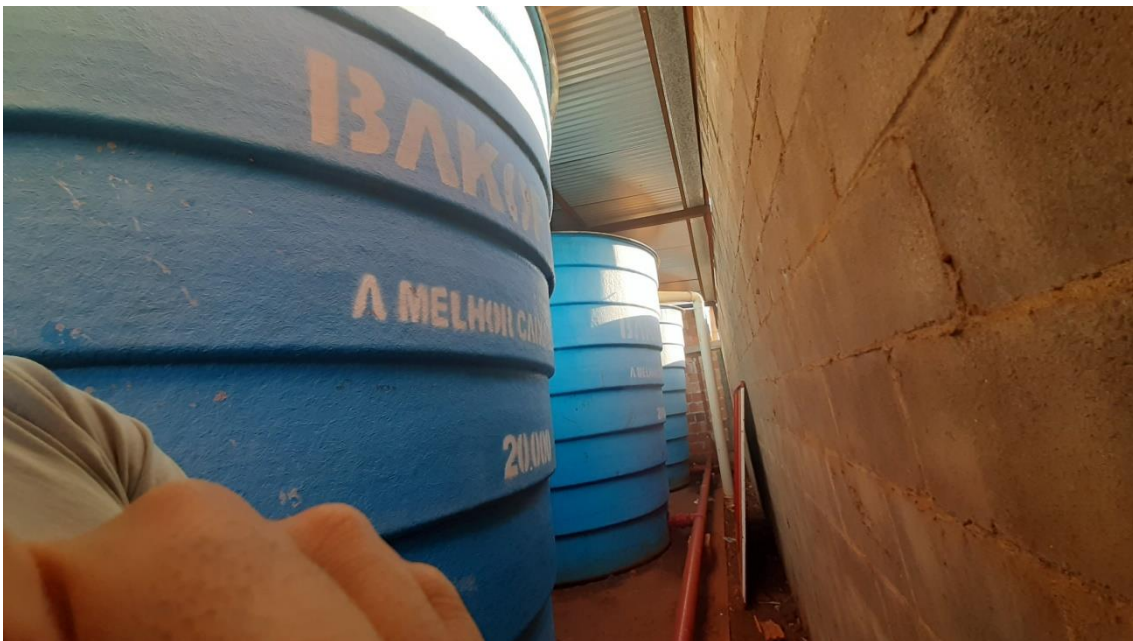
Figura 8 – a) entrada do sistema de abastecimento das cisternas e b) tanques de armazenamento de água, com capacidade nominal de 2000 litros cada. Foto – próprio autor
