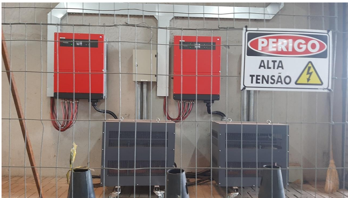
Figura 14 – Inversores dos módulos da usina fotovoltaica instalada Foto: Próprio autor (2020)
