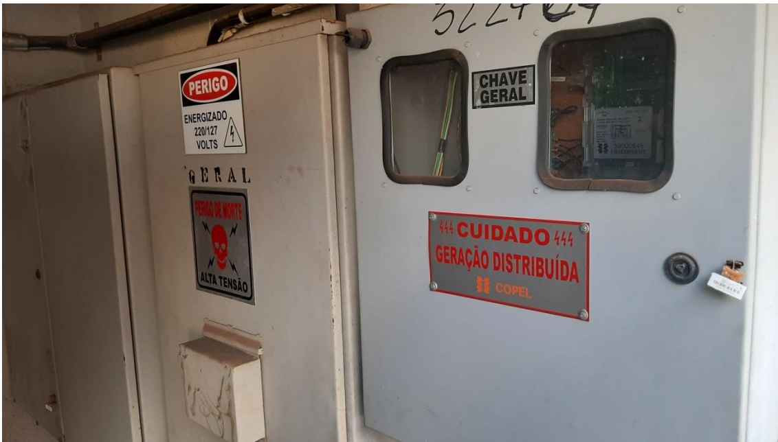
Figura 15 – Chave geral de energia elétrica com indicação da geração distribuída Foto: Próprio autor (2020)
