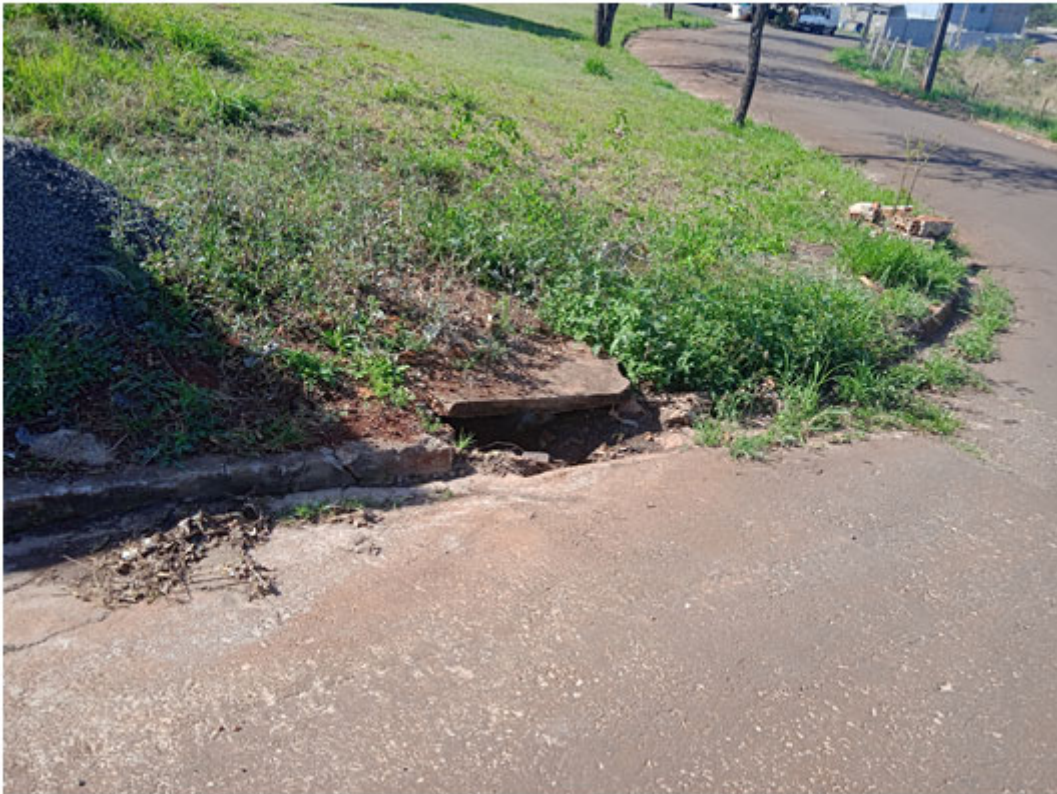
Figura 25: Galeria de coleta de águas pluviais, Rua José Garrido. (Fonte: E.A, 2021).
