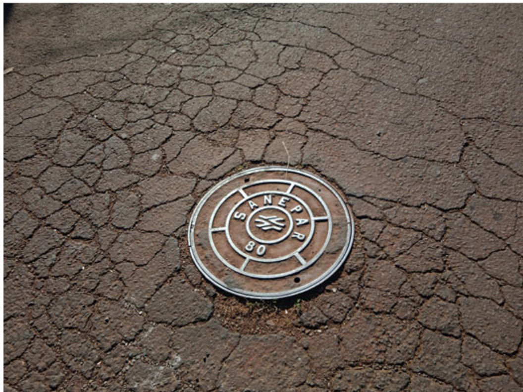
Figura 24: Poço de Visita (PV) (Fonte: E.A, 2021).
