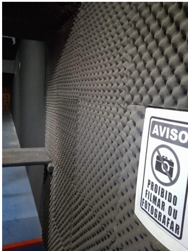
Figura 6: Estande de tiro com espumas de isolamento acústico.
