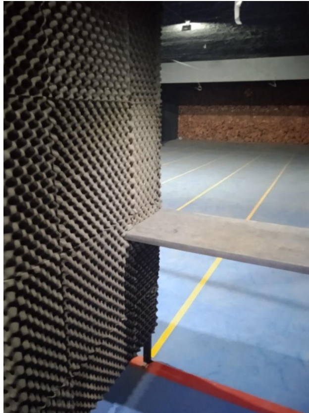
Figura 5: Estande de tiro com espumas de isolamento acústico.
