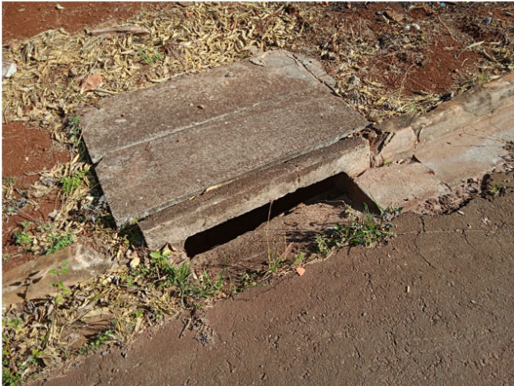
Figura 23: Galeria de coleta de águas pluviais, Rua José Garrido (Fonte: E.A, 2021).
