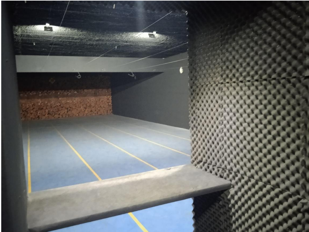
Figura 3: Estande de tiro com espumas de isolamento acústico.
