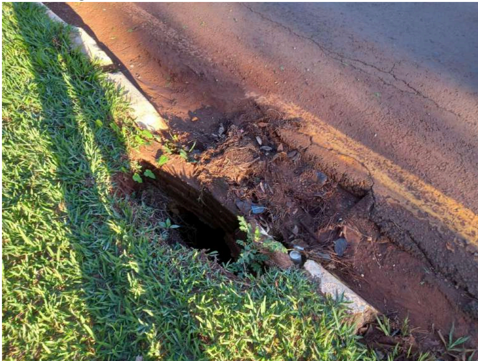
Figura 61- Bocas de Lobo com acúmulo de resíduos na AID.
