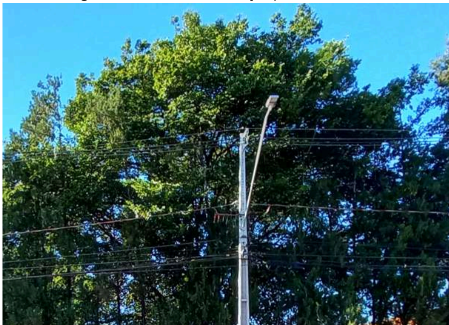
Figura 70- Sistema de iluminação pública no entorno.
