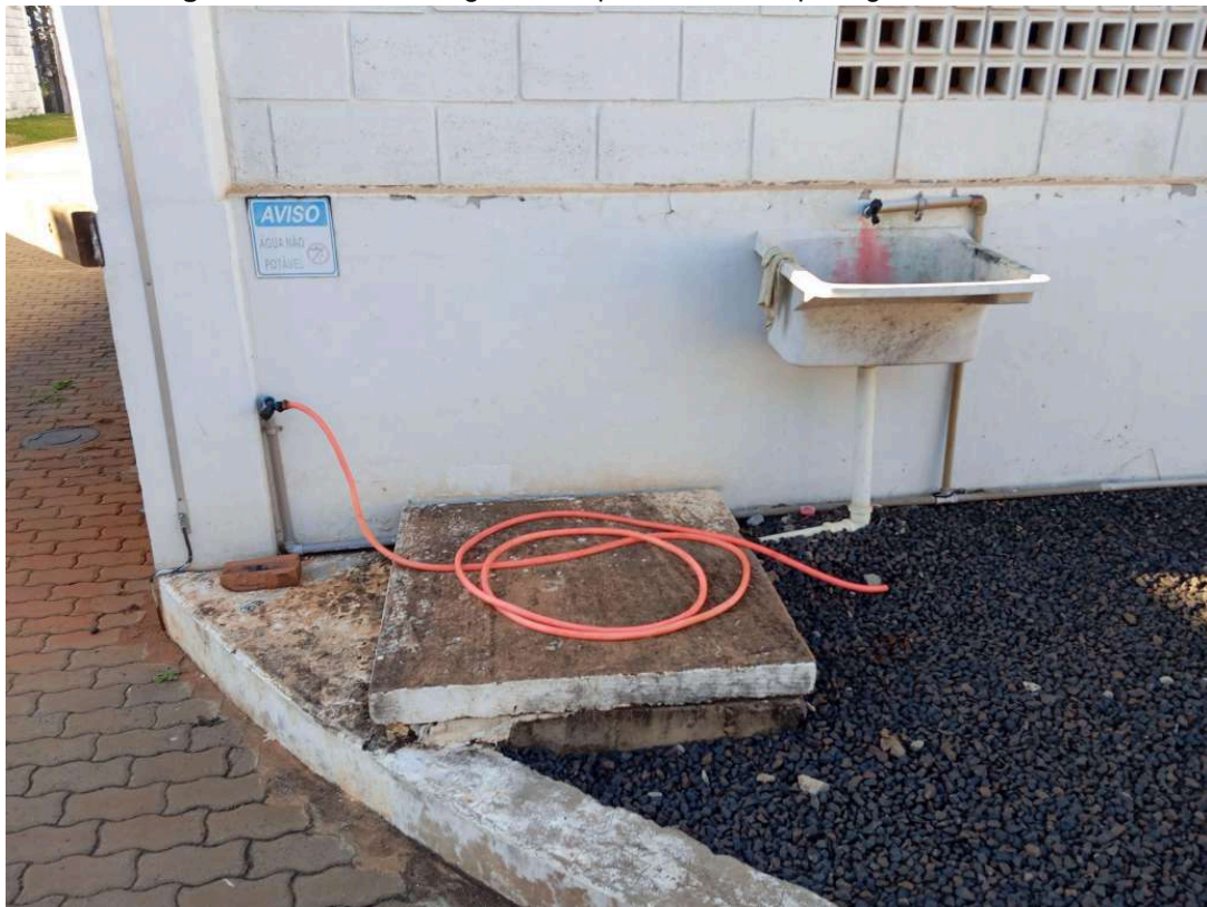
Figura 16- Pontos de água e tanque abastecido por águas de reuso.
