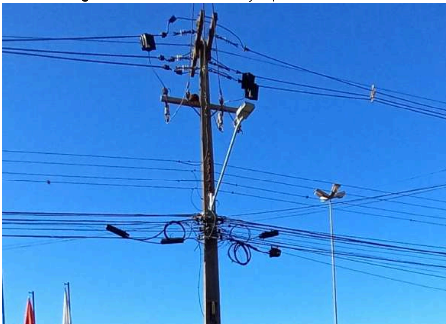
Figura 71- Sistema de iluminação pública no entorno.
