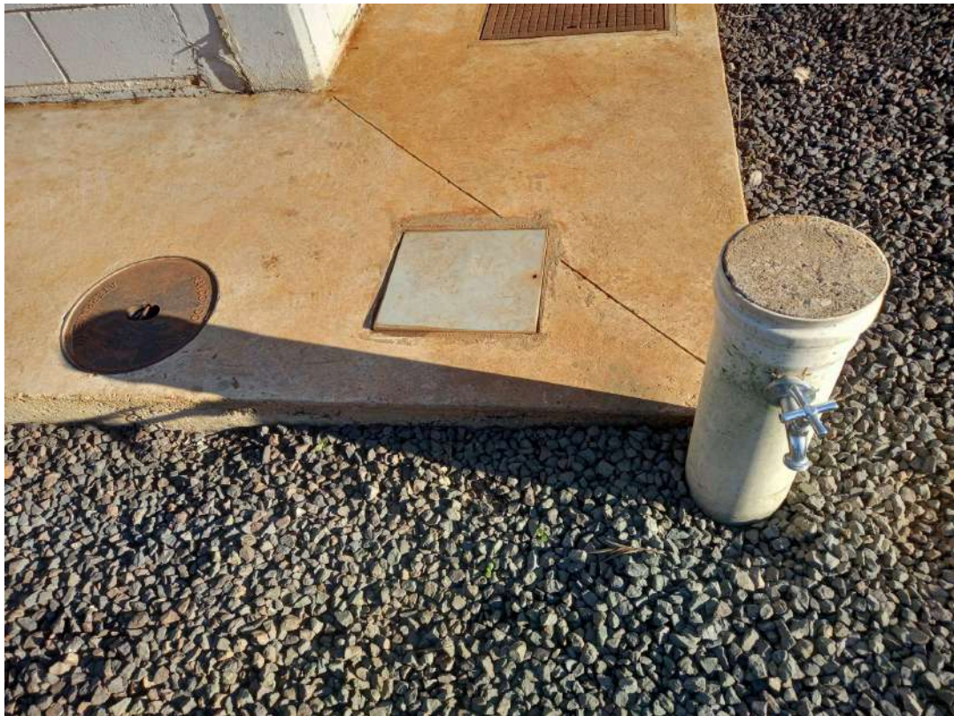
Figura 26- Passeio com caixa de passagens, ponto de água com reuso e área permeável.
