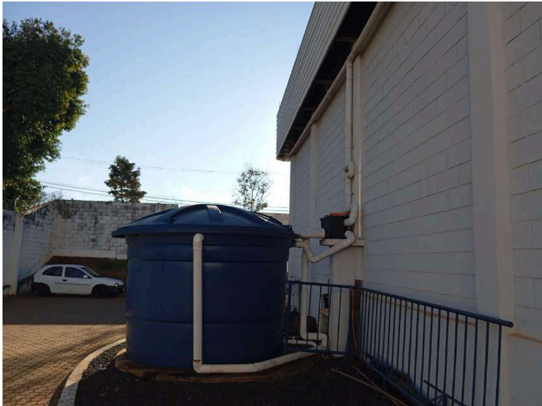
Figura 14- Sistema de captação e reuso de água de chuva.
