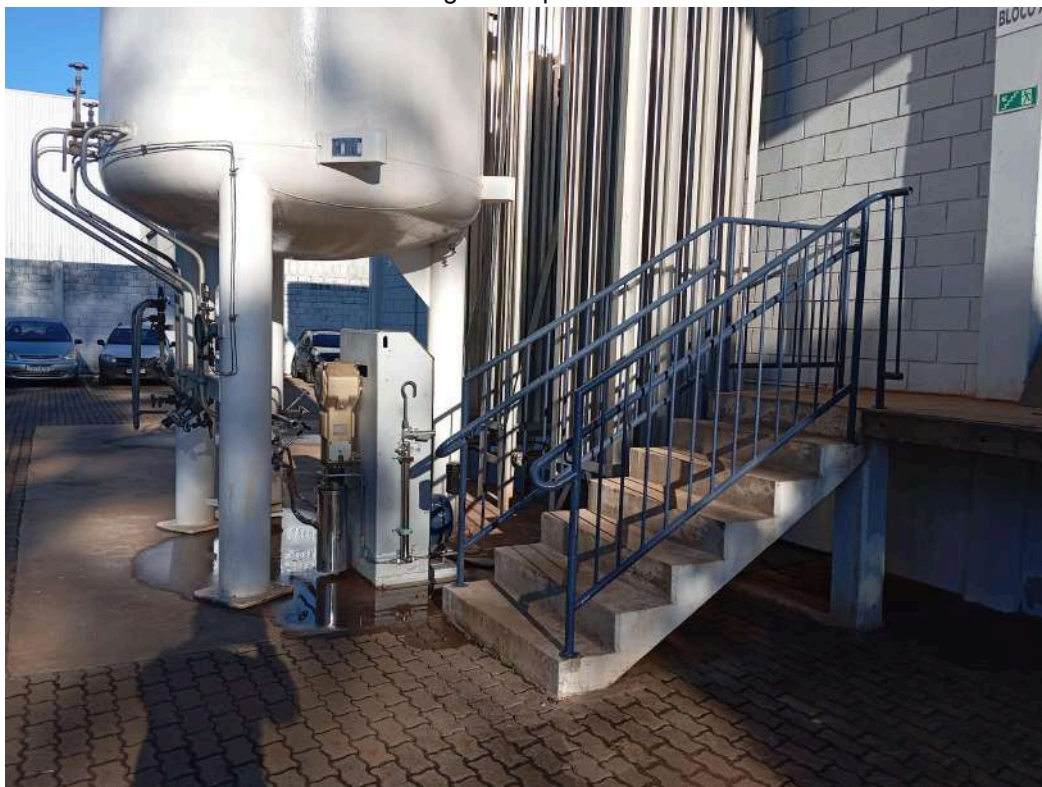
Figura 11- Sistema de válvulas, registros e conexões do tanque, com tubulações de abastecimento e retirada de gases liquefeitos.
