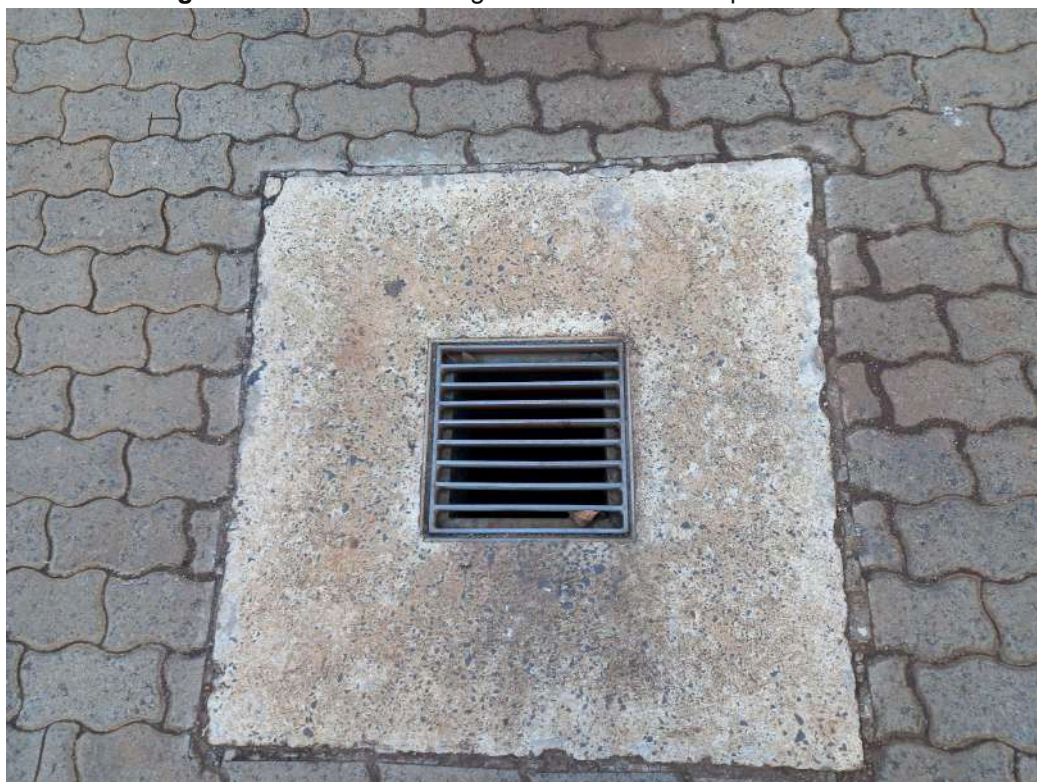
Figura 27- Ponto de drenagem no interior do empreendimento.
