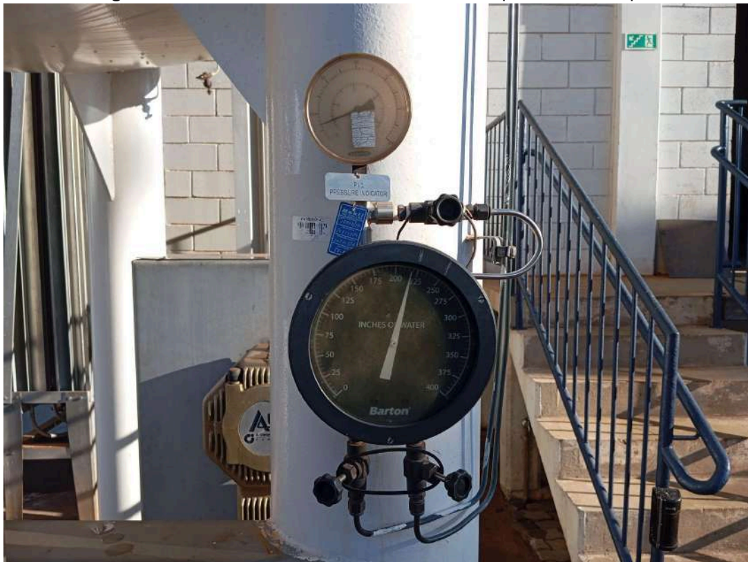
Figura 12- Painel de instrumentos de controle de pressão do tanque.
