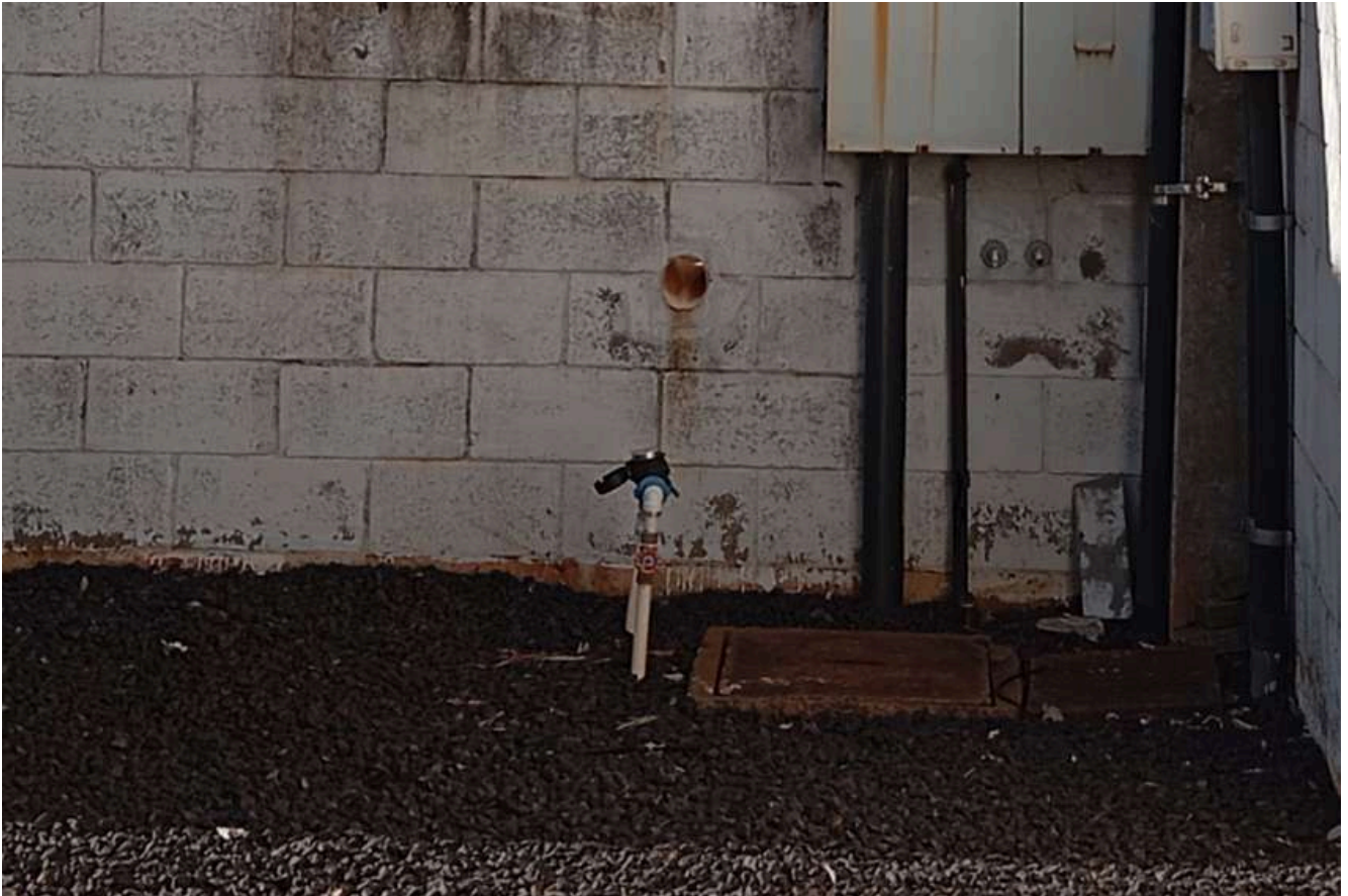
Figura 47- Ponto de abastecimento de água pela Sanepar no empreendimento.
