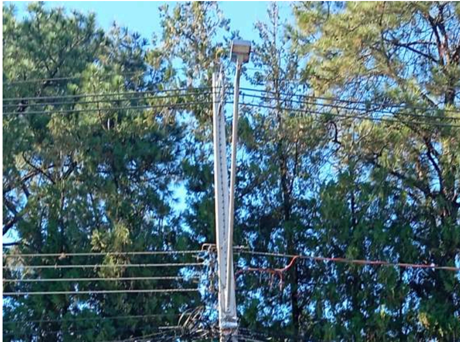
Figura 69- Sistema de iluminação pública no entorno.
