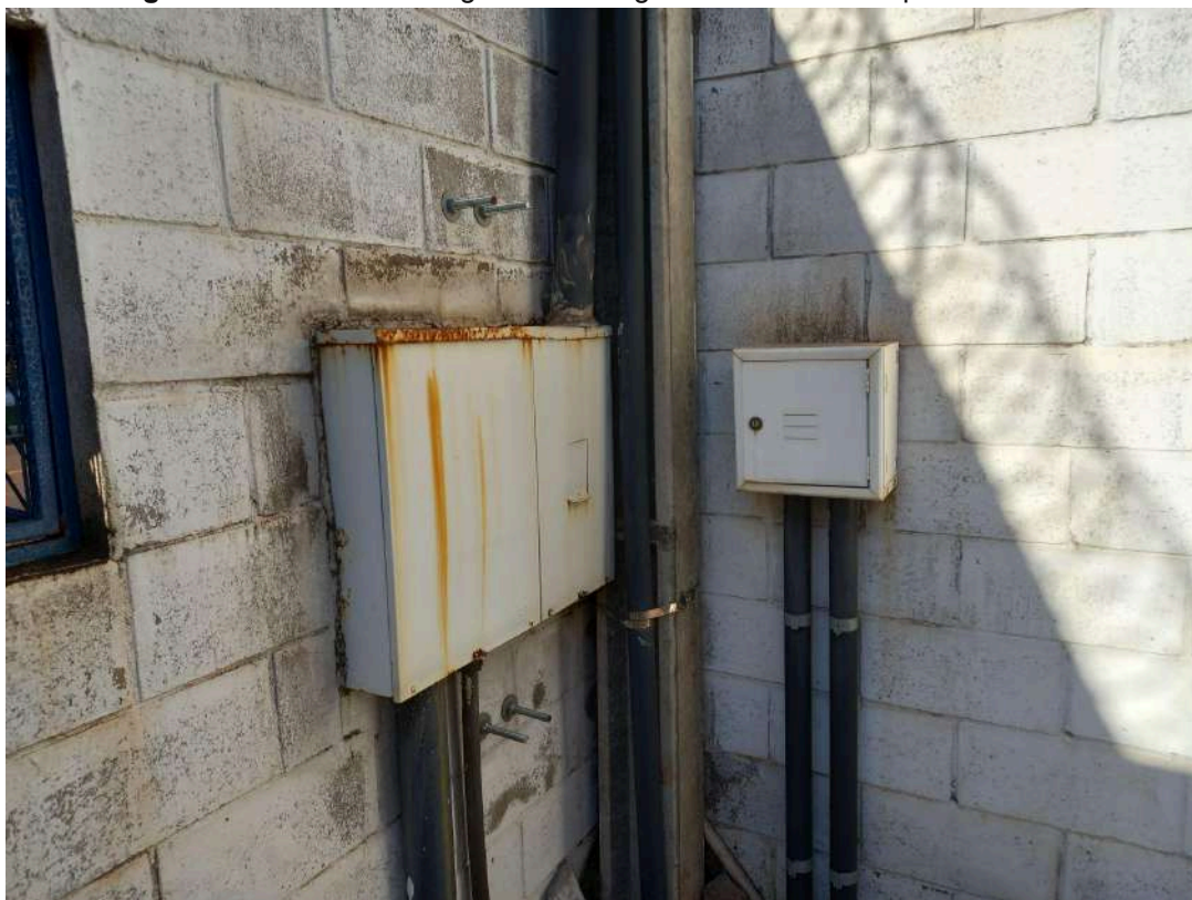
Figura 24- Quadro de chegada de energia no interior do empreendimento.
