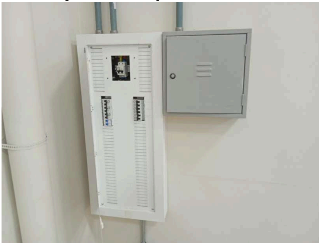
Figura 65- Quadro de energia dentro do estabelecimento.
