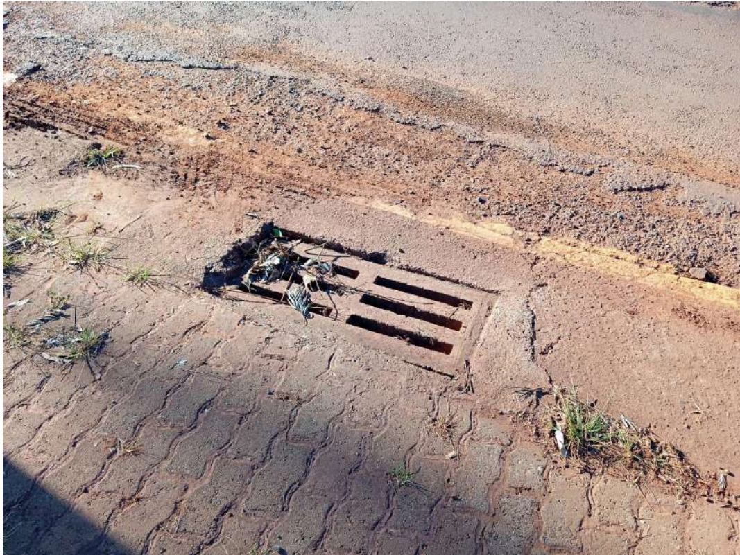
Figura 62- Bocas de Lobo com acúmulo de resíduos na AID.
