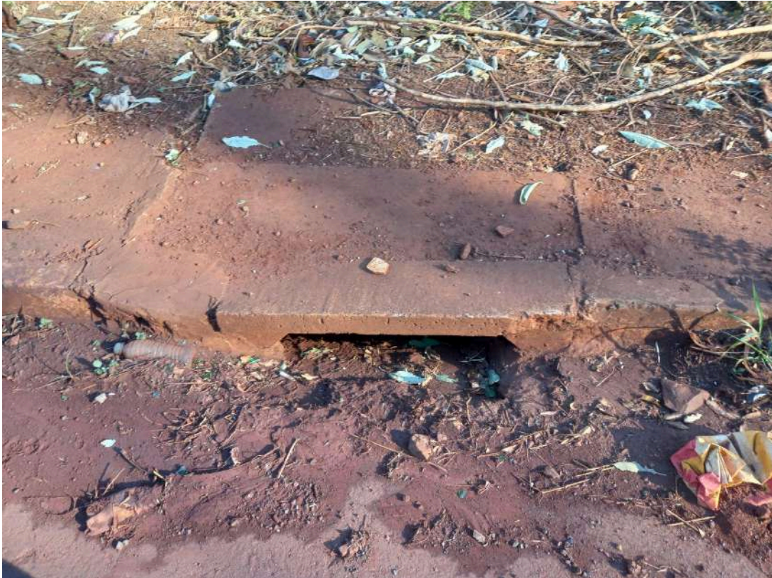
Figura 43- Boca de lobo com acúmulo de resíduos na ponte que atravessa o Ribeirão Cambé.
