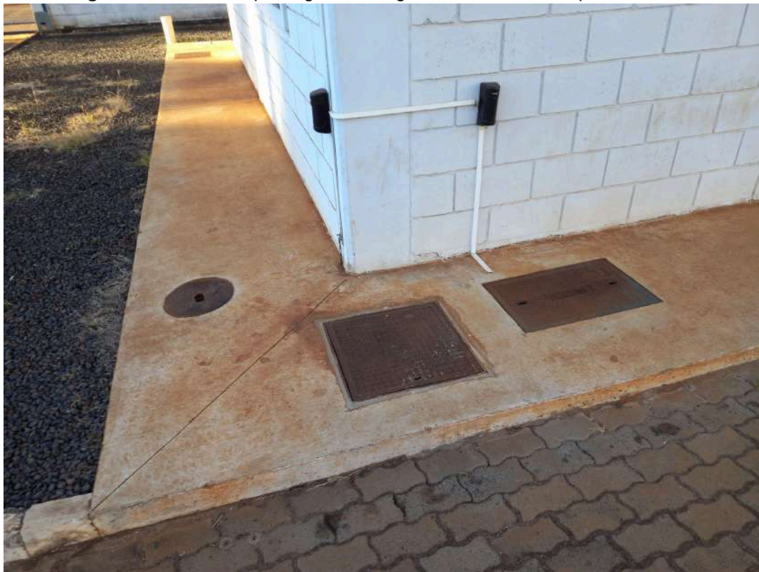
Figura 25- Caixas de passagens de esgoto no interior do empreendimento.
