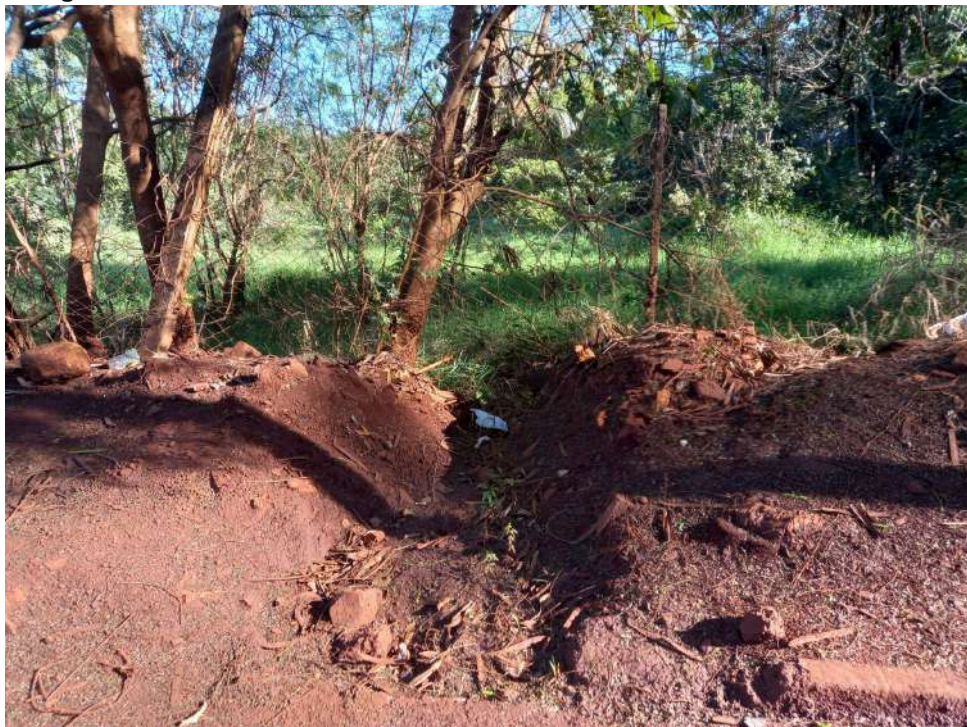
Figura 42- Sinais de erosão no entorno na área de APP do Ribeirão Cambé.
