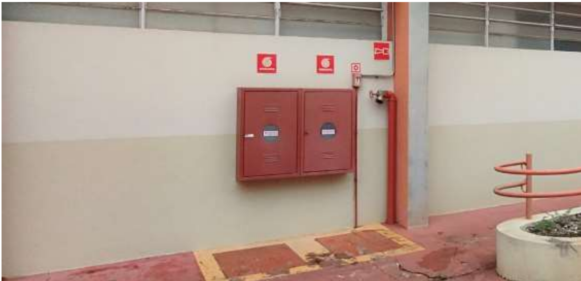
Figura 60 – Vista interna do Campus Clube com Dispositivo de Combate a Incêndio. Fonte: ONE.
