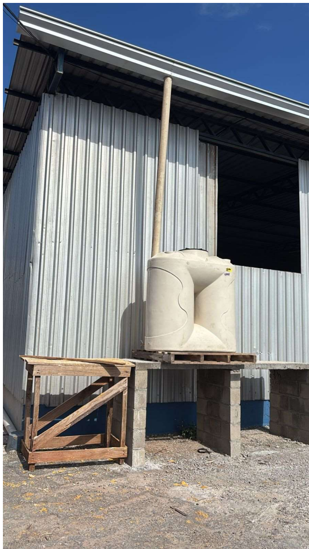
Foto 01 – Sistema de captação e reserva de água pluvial para reaproveitamento.
