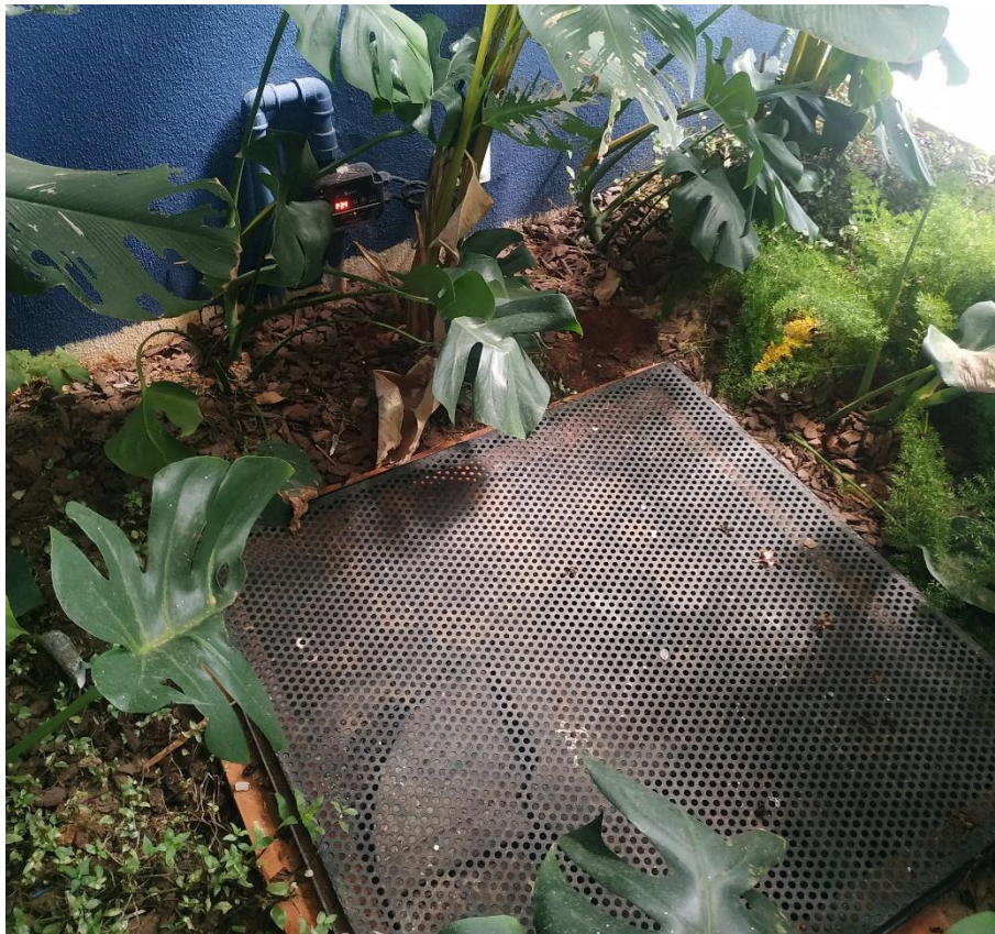
Figura 16: Cisterna de armazenamento e sistema de reaproveitamento de água. Fonte: Master Ambiental, 2024.
