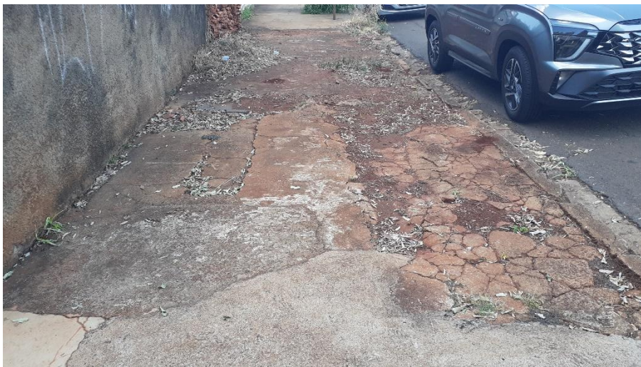
Figura 107: Calçada do entorno em mau estado de conservação e desprovida de dispositivos de acessibilidade. Fonte: Master Ambiental, 2024.
