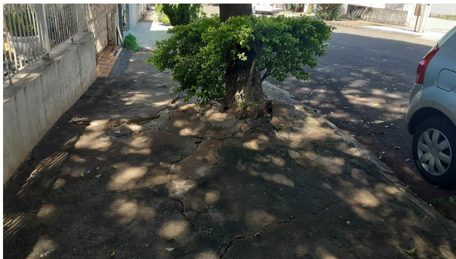
Figura 108: Calçada do entorno em mau estado de conservação e desprovida de dispositivos de acessibilidade. Fonte: Master Ambiental, 2024.
