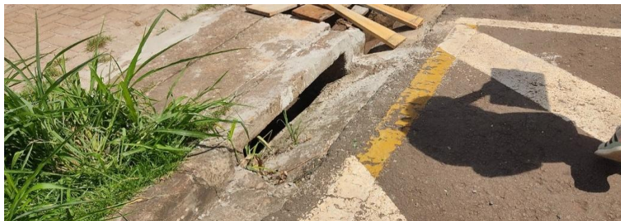
Figura 49: Drenagem pluvial na Av. João Wycliff. Fonte: Master Ambiental, 2024.
