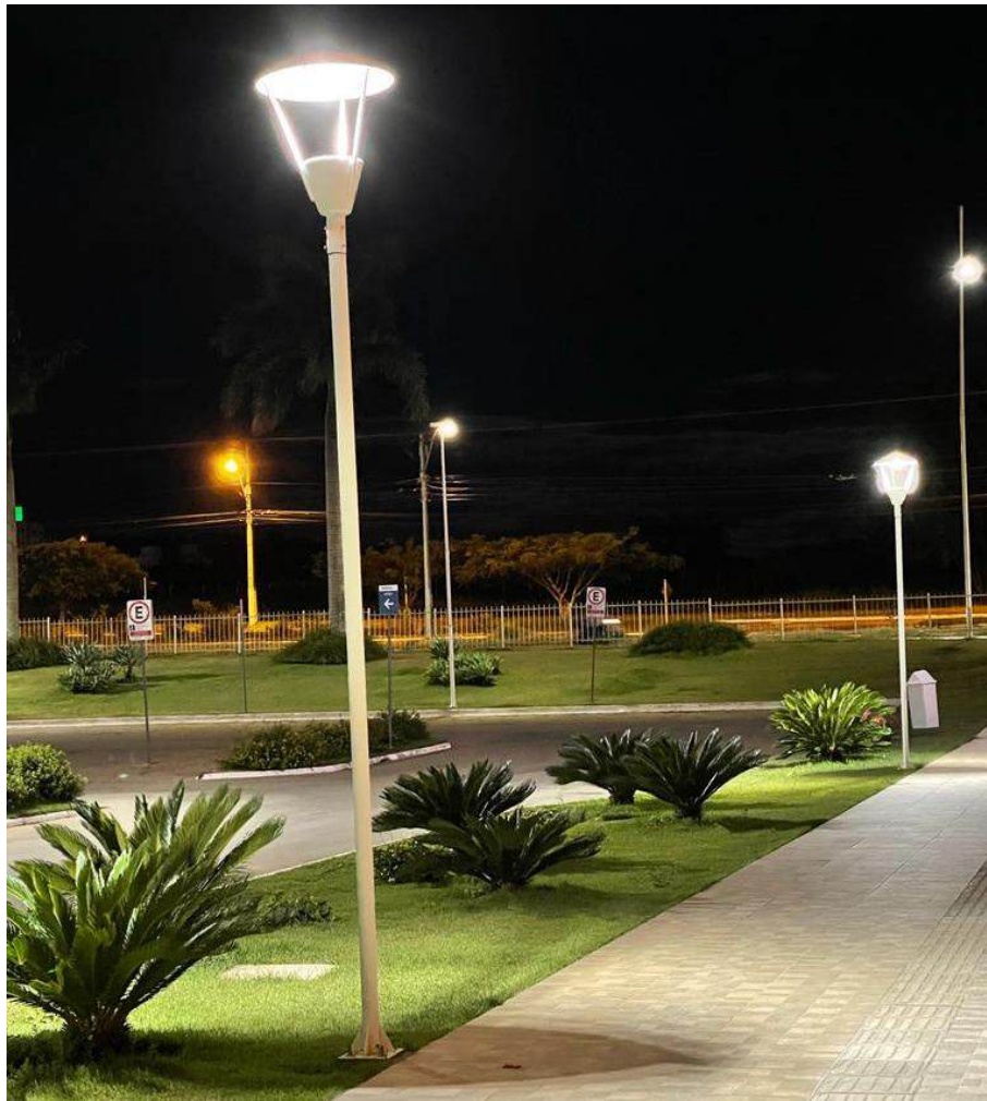
Figura 60: Exemplo de iluminação para áreas externas. Fonte: EMLED.
