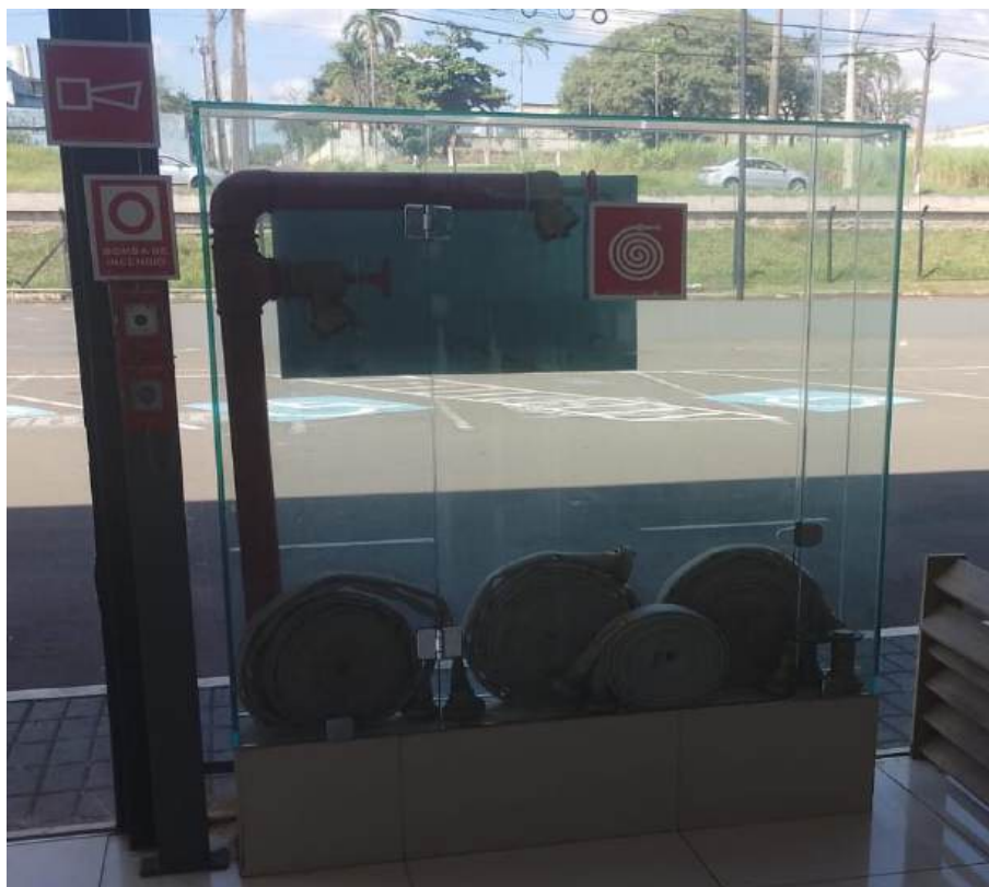
Figura 18: Mangueira de emergência no interior do empreendimento. Fonte: Master Ambiental, 2025.
