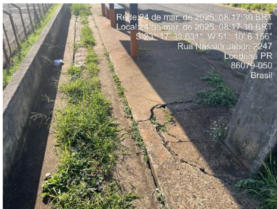
Figura 122: Calçada com pavimentação danificada e piso tátil obstruído na Av. Brasília. Fonte: Master Ambiental, 2025.
