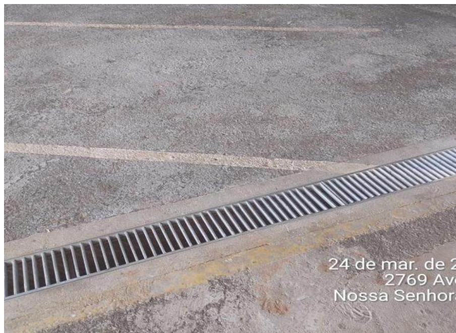
Figura 49: Canaleta metálica na área de estacionamento. Fonte: Master Ambiental, 2025.
