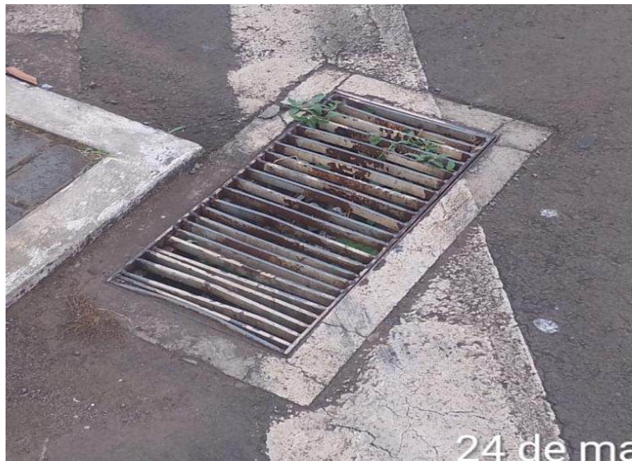
Figura 48: Canaleta metálica na área de estacionamento. Fonte: Master Ambiental, 2025.
