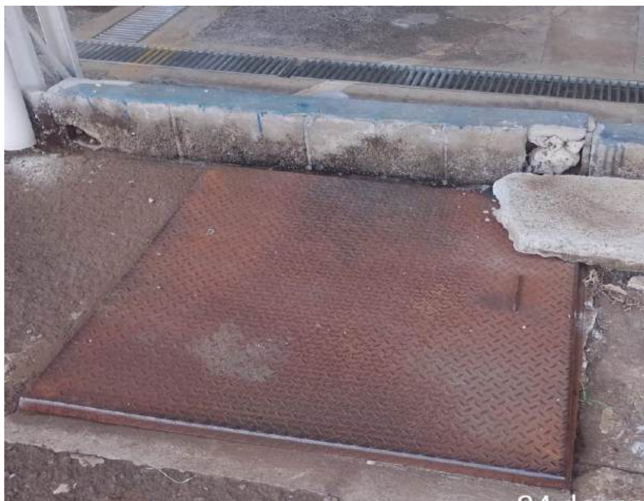
Figura 20: Caixas de inspeção. Fonte: Master Ambiental, 2025.
