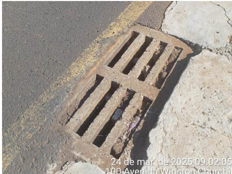
Figura 47: Boca de lobo no entorno do empreendimento. Fonte: Master Ambiental, 2025.
