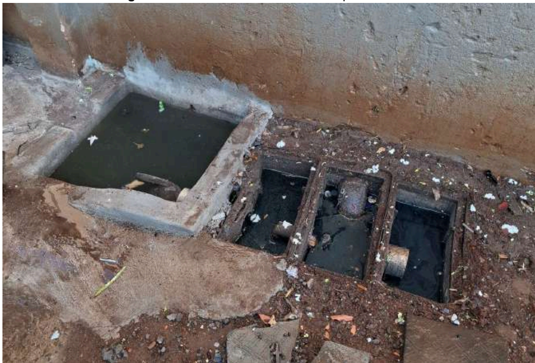
Figura 33- Caixa SAO instalada no empreendimento.
