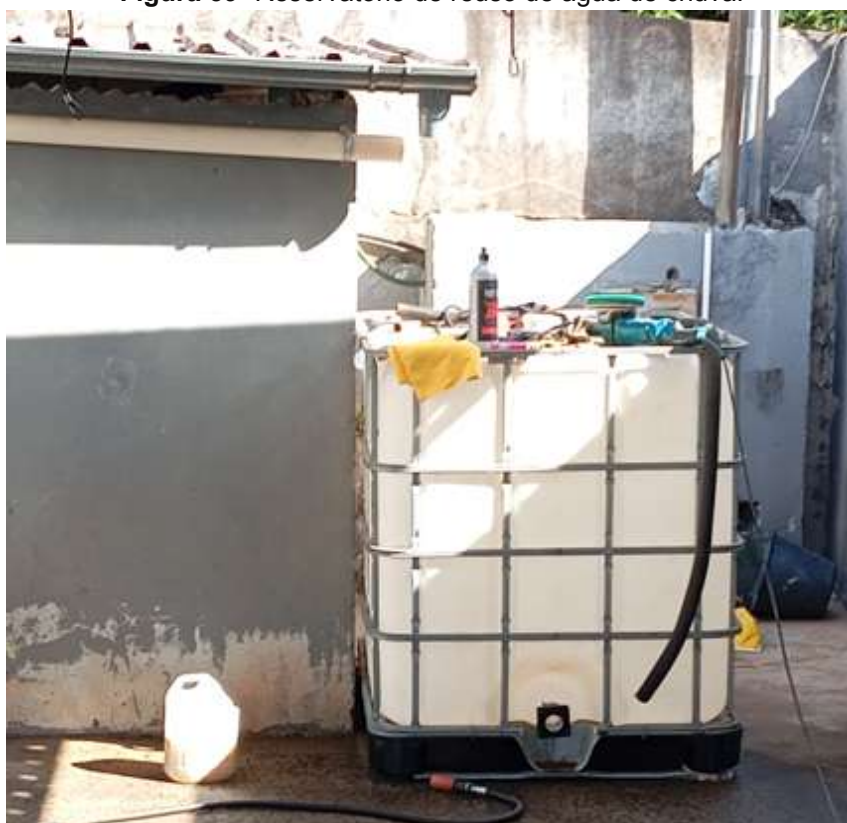
Figura 59- Reservatório de reúso de água de chuva.
