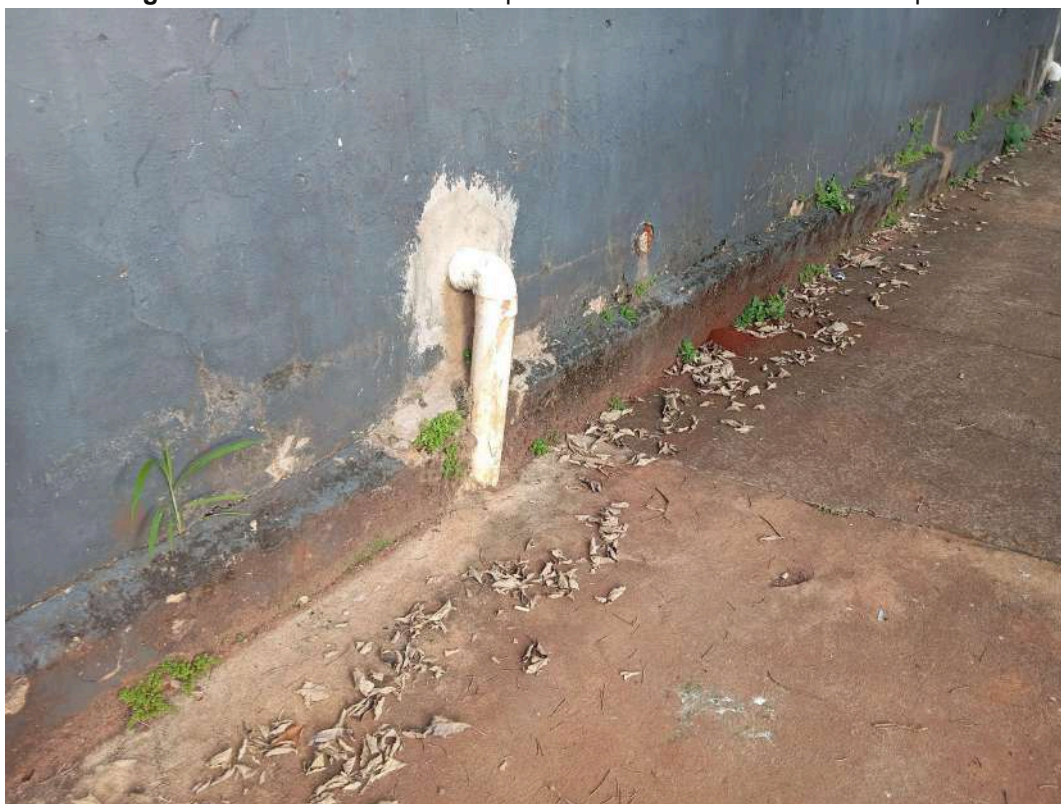
Figura 34- Saída da Caixa SAO para conexão com a rede da Sanepar.
