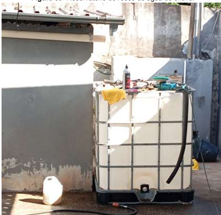
Figura 59- Reservatório de reúso de água de chuva.
