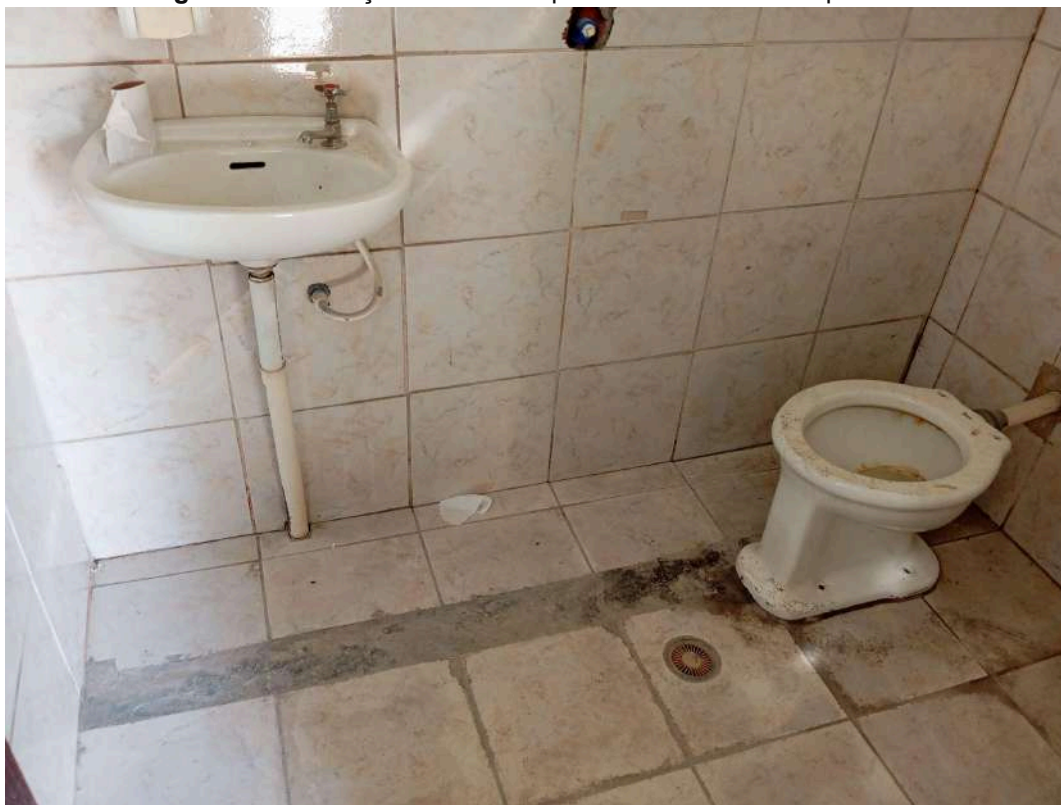
Figura 11- Instalações Sanitárias próxima as cabines de pinturas.
