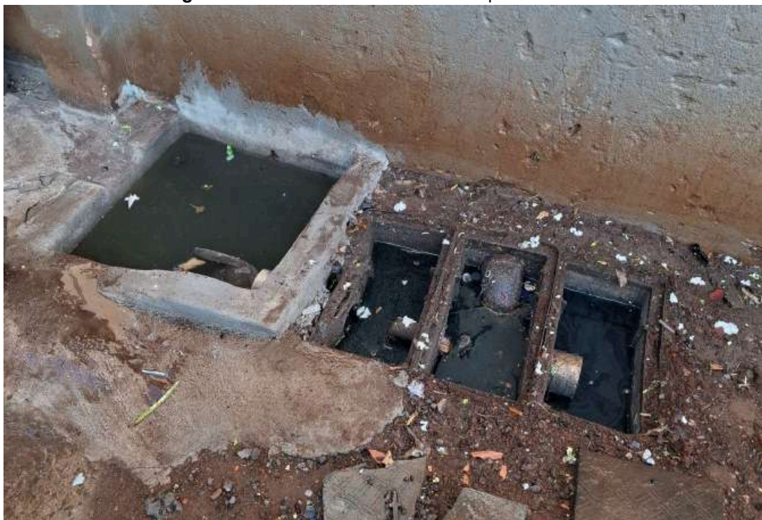
Figura 33- Caixa SAO instalada no empreendimento.
