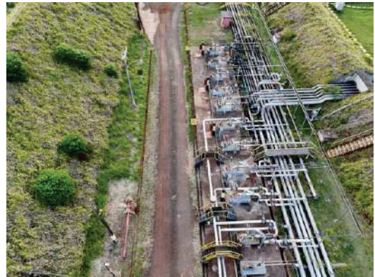
Figura 10 - Vista aérea do rack central de tubulações entre os diques de contenção, com válvulas e medidores de fluxo
