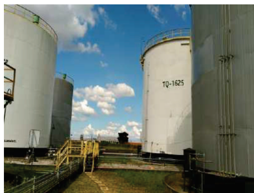
Figura 8 - Tanques TQ-1625 e adjacentes com tubulações, escadas de acesso e diques de contenção
