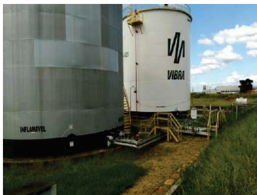
Figura 7 - Tanque TQ-1625 com identidade visual Vibra e sinalização 'INFLAMÁVEL'
