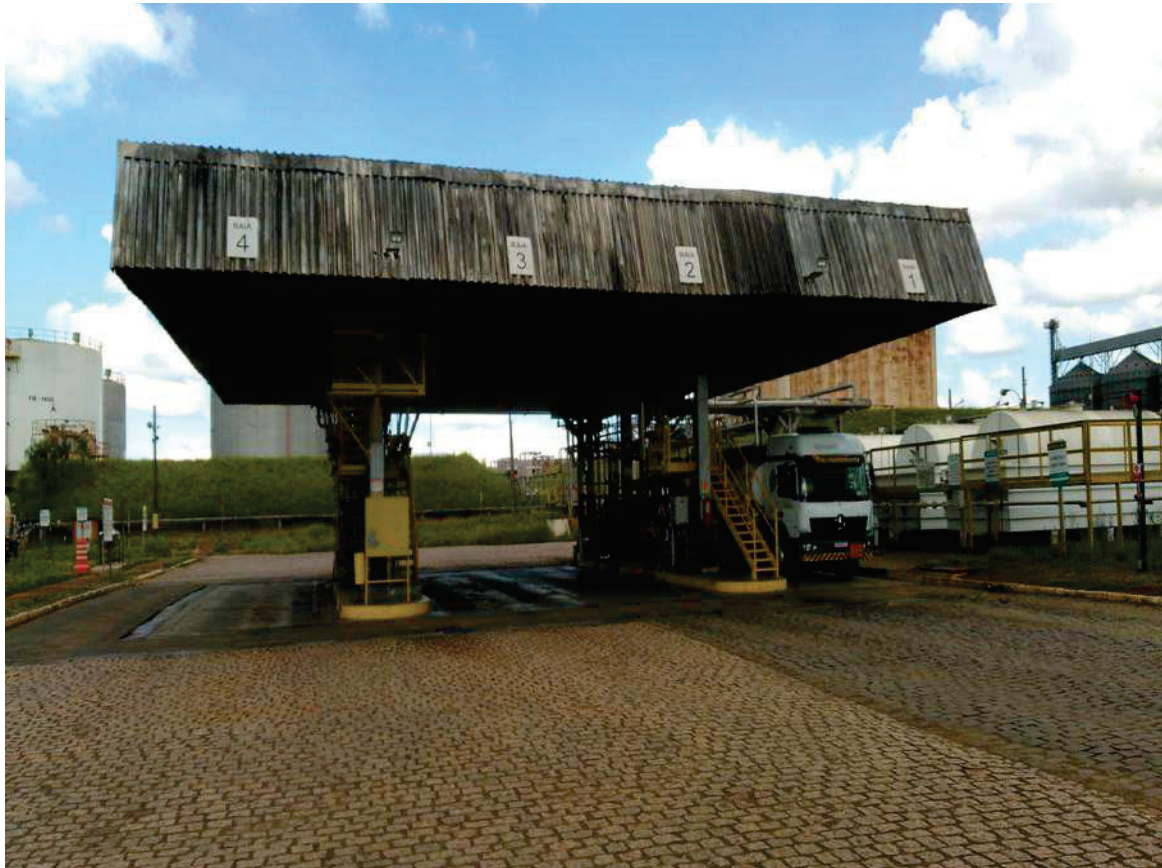
Figura 11 - Plataforma de carregamento de caminhões-tanque, cobertura metálica e braços de carregamento superior
