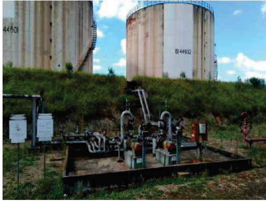
Figura 9 - Tanques aéreos 6I-44601 e 6I-44602 (etanol) com sistema de bombeamento, manifold e placa de 'Risco de Explosão'
