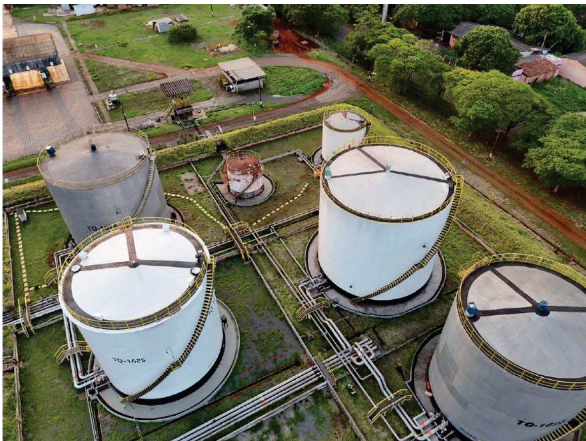
Figura 6 - Detalhe aéreo dos tanques TQ-1625 e TQ-1622, evidenciando os diques de contenção individuais, as tubulações de interligação e as escadas de acesso com guarda-corpos em amarelo, em conformidade com as normas de segurança
