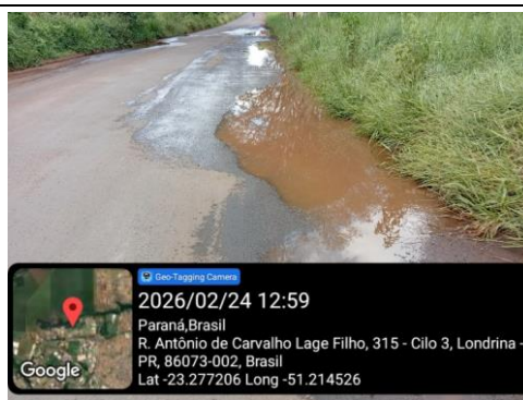
Figura 32. Registro de alagamento.
