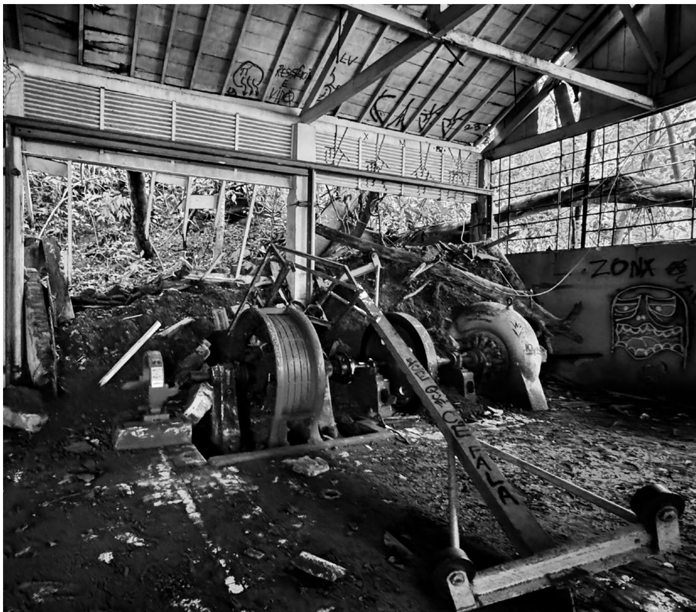
Situação atual da histórica primeira usina hidrelétrica de Londrina, soterrada pelas chuvas de 2016
