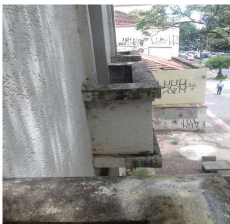
Sacada da Biblioteca antes da lavagem
