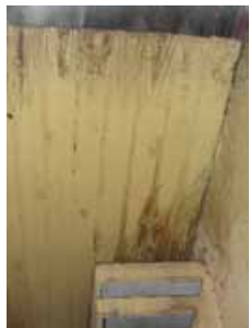
Foto referente a infiltração.
