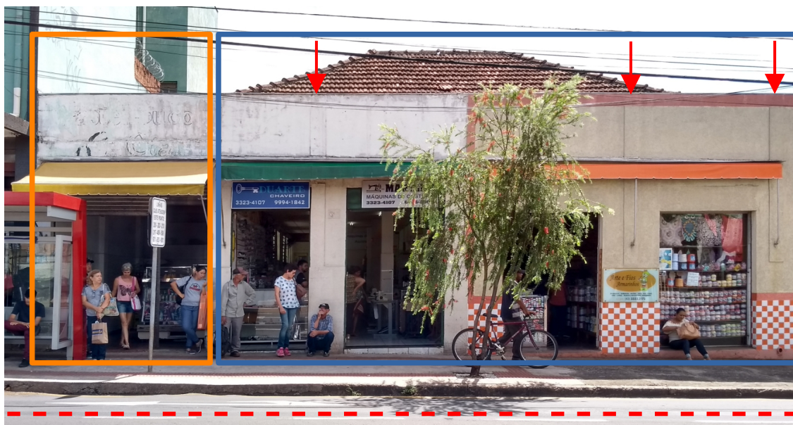
— Edifício original (1944 / 1986) — Aumento incorporado em 1976 — Avenida Duque de Caxias —> Detalhes de frisos em relevo (projeto de 1944)
