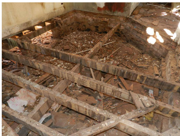
Foto da estrutura do piso durante a demolição, 2013 Fotógrafo: José RoberStones Pieretti
