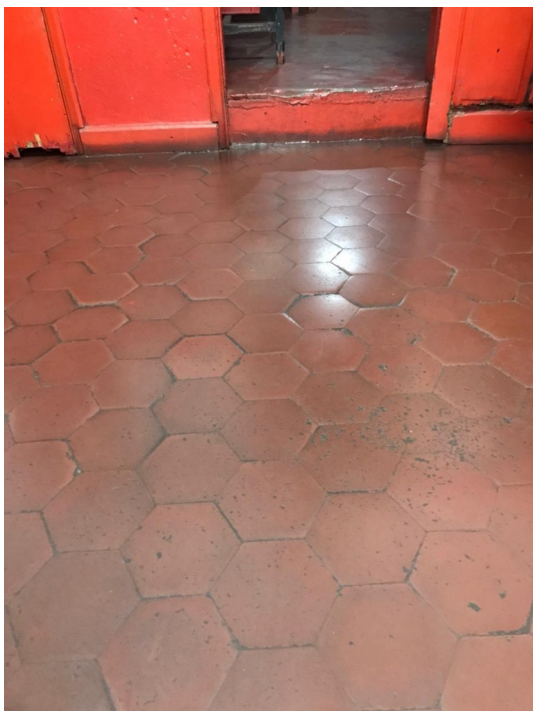
Registro fotográfico de 2021 – detalhe piso interno do sobrado misto (1959). Fonte: Rodrigues, 2021. Acervo do Projeto de Pesquisa 10102/UEL.
