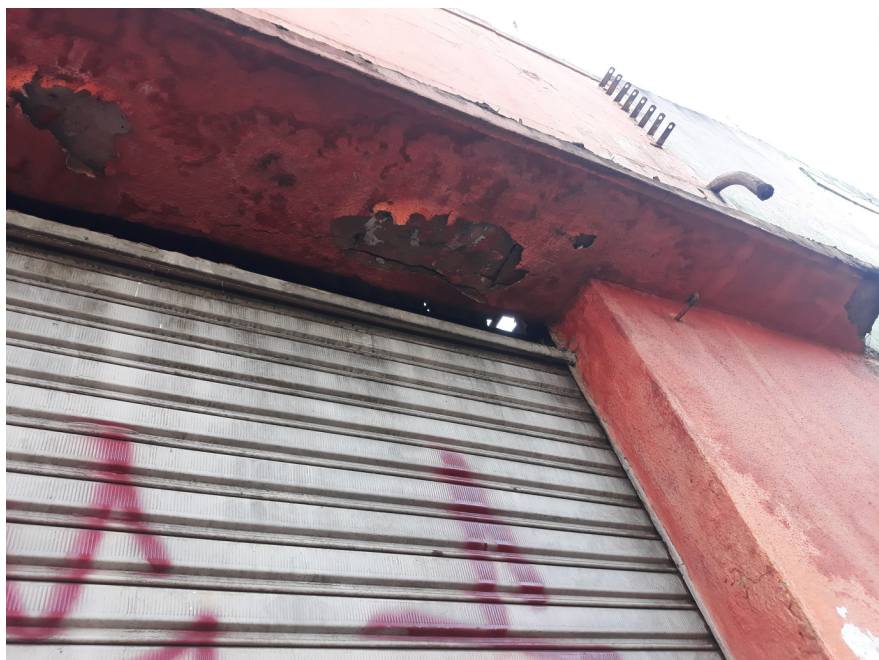
Registro fotográfico de 2020. Deterioração da marquise, do forro e do telhado. Deterioração da pintura e partes metálicas Autora: Nathália I. N. Shimizu. Fonte: Rodrigues, 2019
