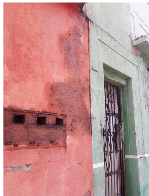
Registro fotográfico de 2019, Deterioração da pintura e partes metálicas Autora: Nathália I. N. Shimizu. Fonte: Rodrigues, 2019
