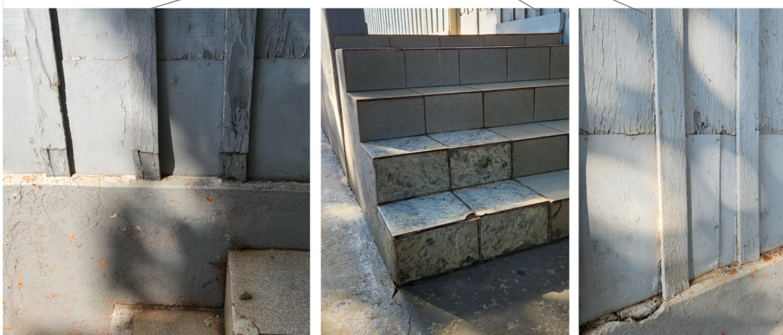
Patologias da fachada frontal da Escola Municipal Padre Anchieta Fonte: os autores (2023).
