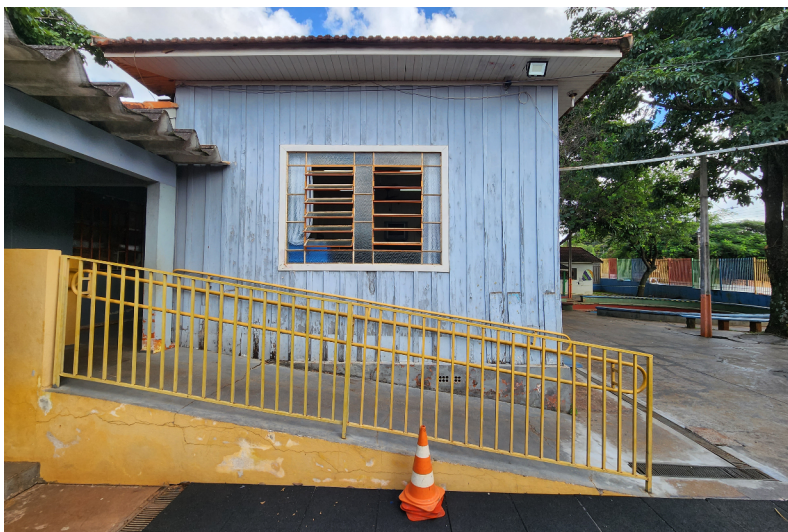
Patologias da fachada lateral da Escola Municipal Padre Anchieta Fonte: os autores (2023).
