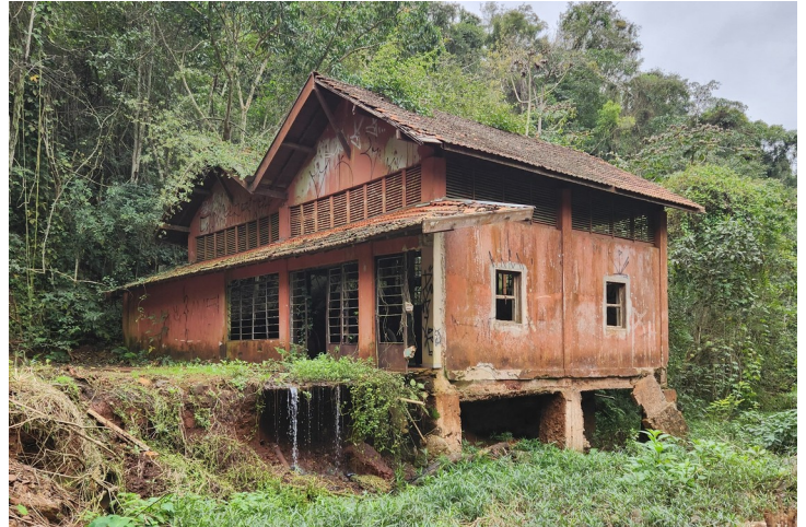
Estrutura remanescente da Casa de Máquinas da Usina
