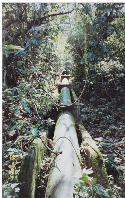
Conduto forçado, 2001 Fonte: Acervo de Mangili Jr. (2025).
